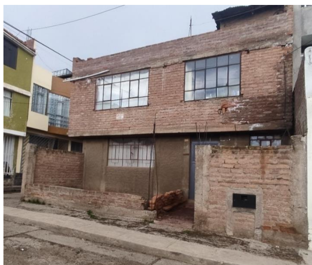
Figura 5.6 Humedad en elementos estructurales
