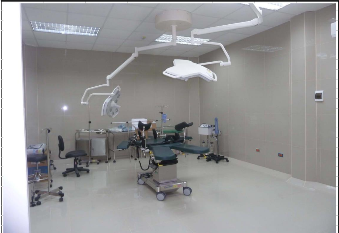
EN LA VISTA SE APRECIA LA CULMINACIÓN DE LA SALA DE OPERACIONES CON EL EQUIPAMIENTO NECESARIO CONFORME A LAS ESPECIFICACIONES TÉCNICAS DEL EXPEDIENTE TÉCNICO DEL PROYECTO “MEJORAMIENTO DE LOS SERVICIOS DE SALUD DEL CENTRO DE SALUD DE SANTA ANA, DE LA MICRO RED SANTANA, RED HUANCAVELICA”
