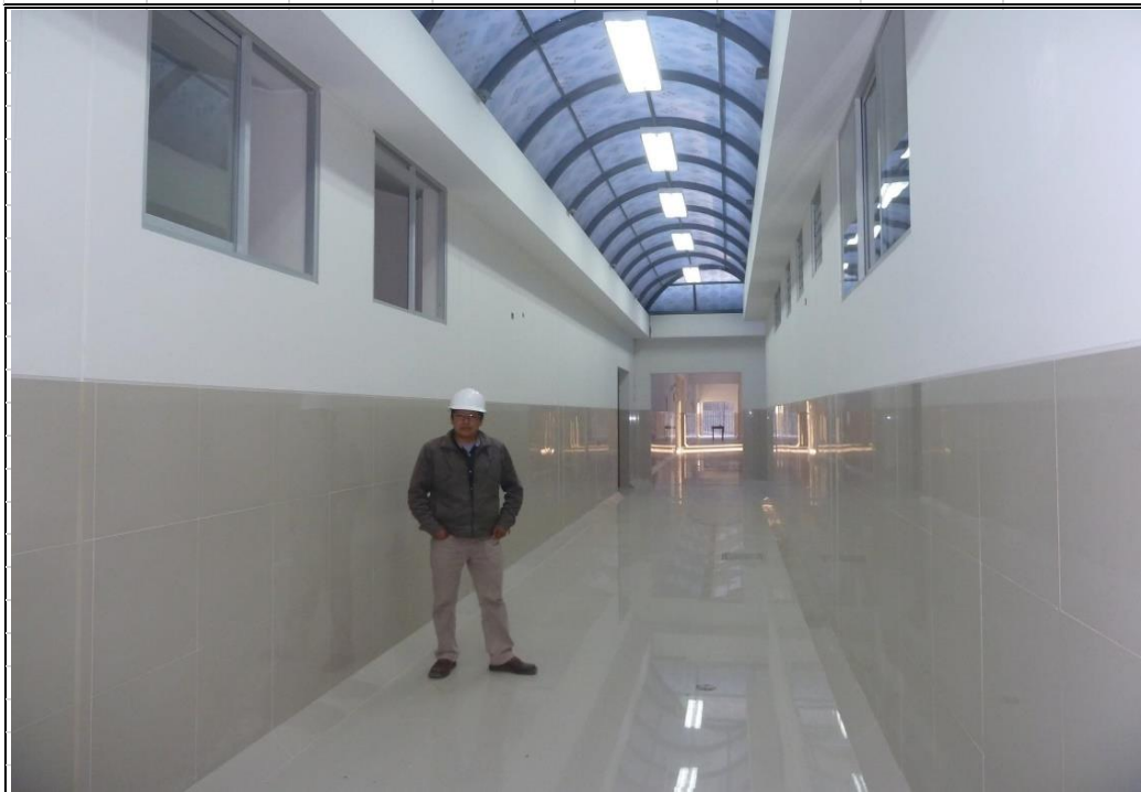
EN LA VISTA SE APRECIA LA CULMINACIÓN DE TODOS LOS TRABAJOS DE ACABADOS, PISOS DE PORCELANATOS, PAREDES TARRAJEADAS Y PINTADAS, CON INSTALACIONES ELÉCTRICAS, SANITARIAS, CÁMARAS, SISTEMAS CONTRA INCENDIO, VENTANAS, EN LOS ACCESOS Y PASADIZOS EN EL PROYECTO “MEJORAMIENTO DE LOS SERVICIOS DE SALUD DEL CENTRO DE SALUD DE SANTA ANA, DE LA MICRO RED SANTANA, RED HUANCAVELICA”
