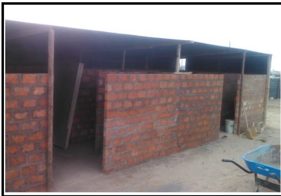
Imagen 81 Servicios higiénicos para obra.
