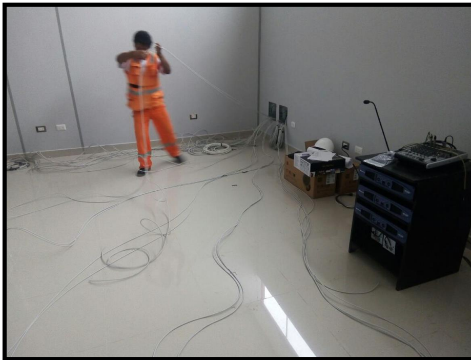
Imagen 70 Cableado de data
