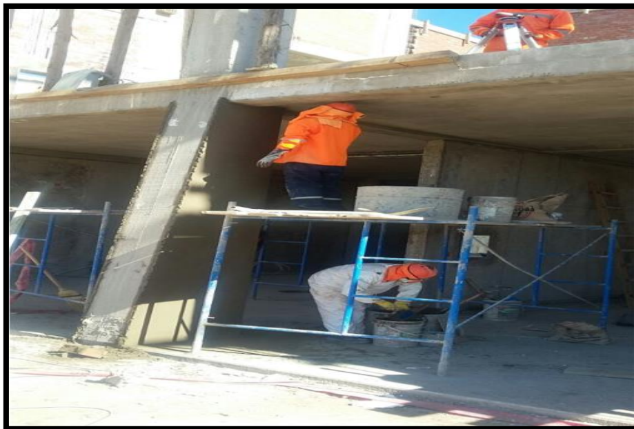
Imagen 131 Tarrajeo en columnas.
