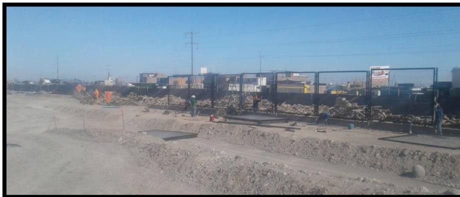
Imagen 280 Instalación de CERCO DE MALLA CUADRADA DE 2" X 2" MARCO DE TUBO CIRCULAR DE 2"
