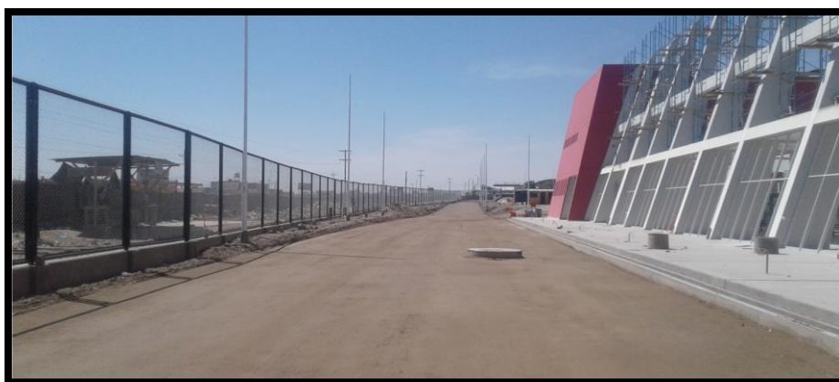
Imagen 282 Instalación de CERCO DE MALLA CUADRADA DE 2" X 2" MARCO DE TUBO CIRCULAR DE 2"
