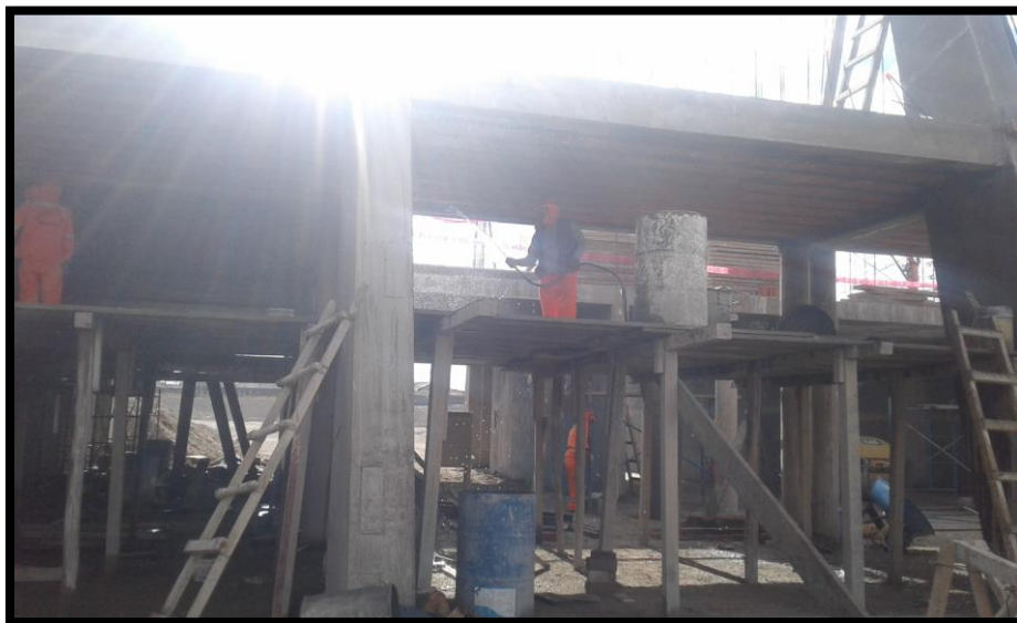
Imagen 140 Humedecimiento de cielo raso antes de colocar el tarrajeo.
