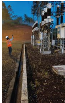
Ilustración 2: Termografía a la llegada de la línea LT-6044 60kV subestación Cajamarca
