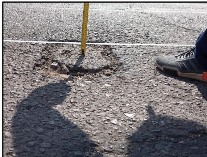
Figura 44: Falla por hundimiento. Fuente: Elaboración propia.
