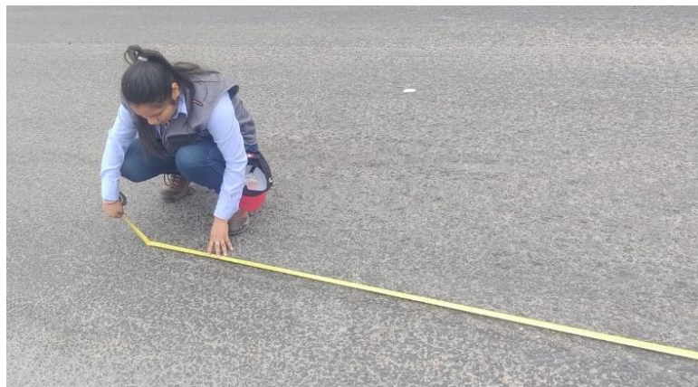
Figura 42: Medición de grieta longitudinal y transversal. Fuente: Elaboración propia.
