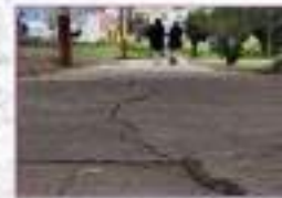
VIA UTILIZABLE, existencia de grietas y piso levantado, sin acceso a rampas. Ubicación paralela a la Av. Calvario del Sol
