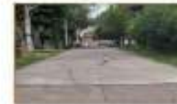
VIA DETERIORADA, con pequeñas rajaduras y sin acceso a rampas.
