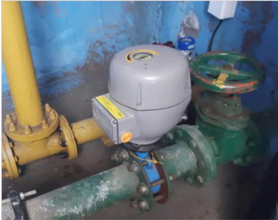
Figura 38. Electroválvula reservorio R-37 Vista lateral
