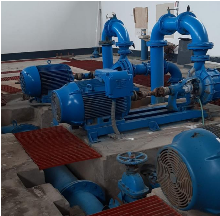
Figura 59. Estación de bombeo R-13ª
