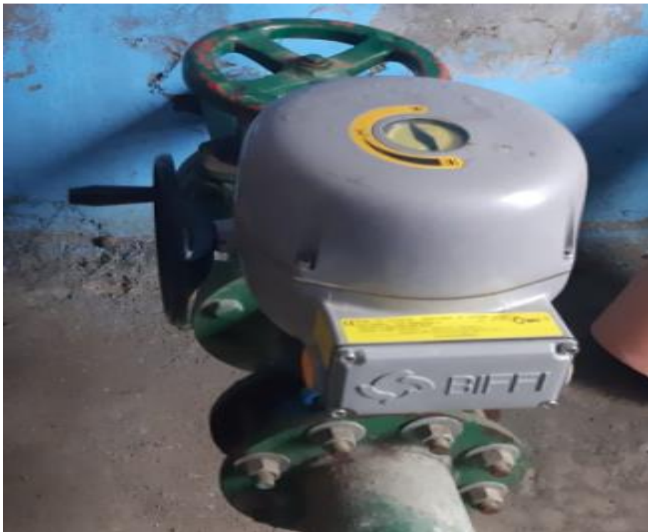
Figura 39. Electroválvula reservorio R-37 vista frontal
