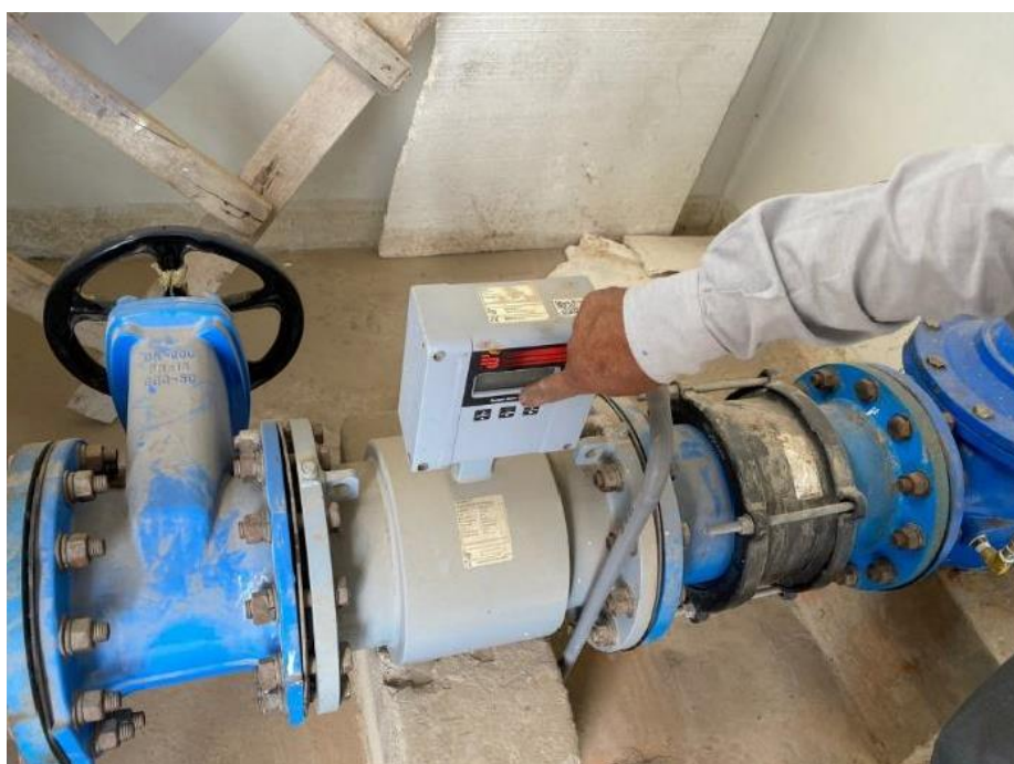
Figura 96. Cámara bombeo N-45 – Caudalímetro sin conexión Fuente: Elaboración propia
