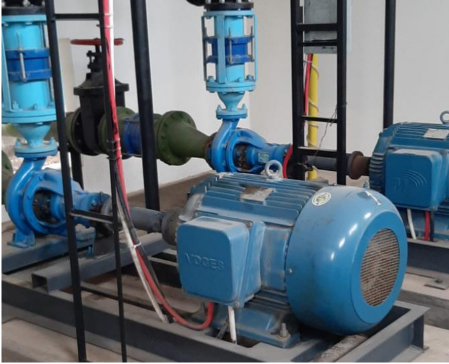
Figura 58. Estación de bombeo R-13
