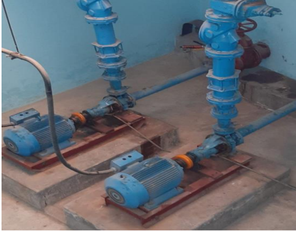
Figura 56. Estación de bombeo N-26B
