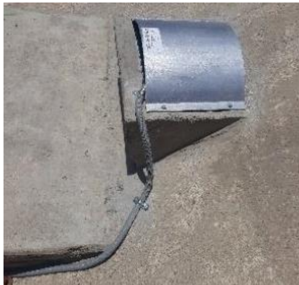
Figura 45. Sensor de radar instalado en reservorio R-13
