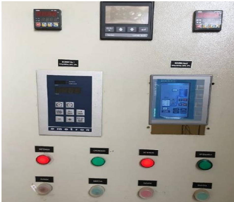
Figura 53. Tablero de fuerza cámara bombeo Reservorio N-26B
