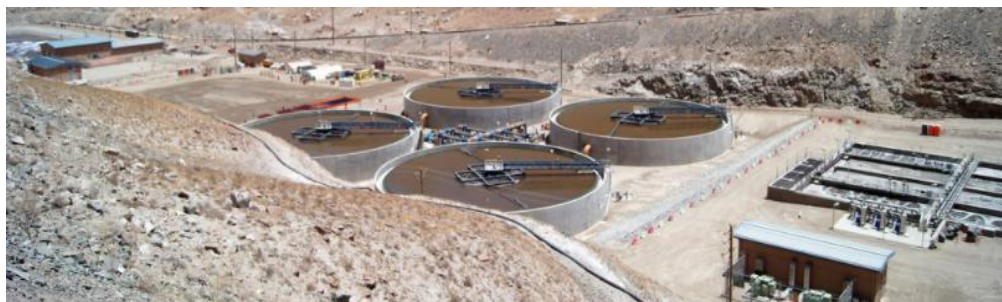
Figura 7. Segunda Planta de tratamiento de aguas residuales - La Enlozada.
