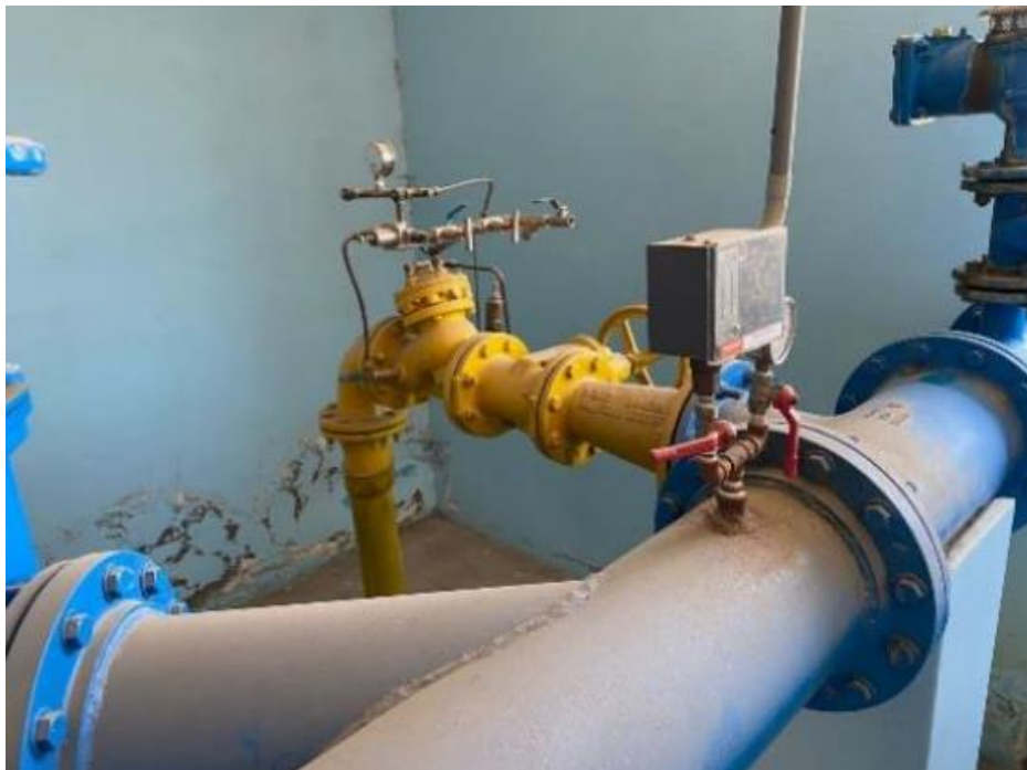
Figura 94. Reservoirio N-26B – Instrumentación sin conexión
