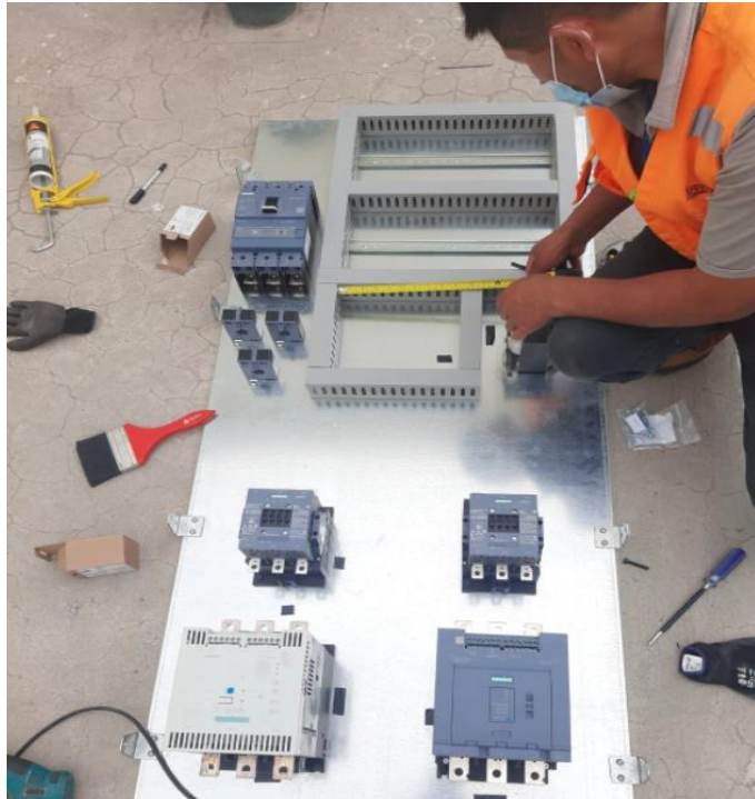
Figura 75. Instalación de equipos electrónicos PLC, Arrancadores suaves de motores en el gabinete de comunicaciones.
