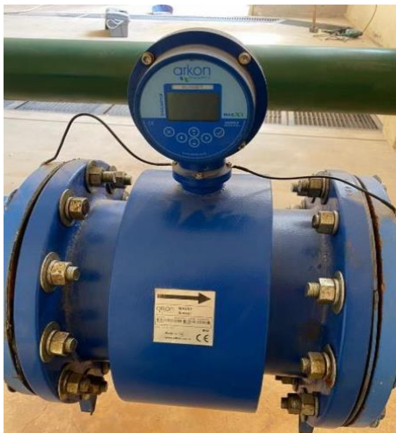
Figura 95. Reservorio N-26B – Caudalímetro sin conexión Fuente: Elaboración propia
