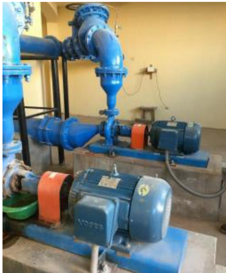
Figura 50. Cámara de Bombeo Reservorio N-26B
