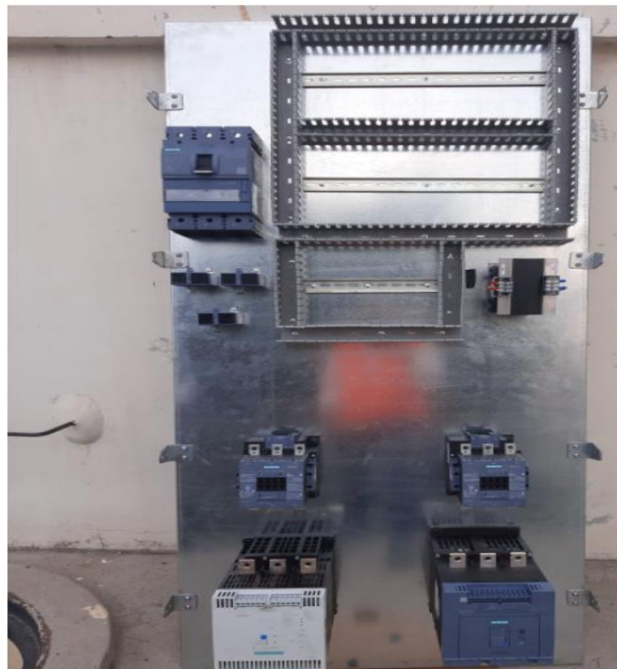
Figura 76. Presentación preliminar de los equipos electrónicos en el gabinete de comunicaciones.
