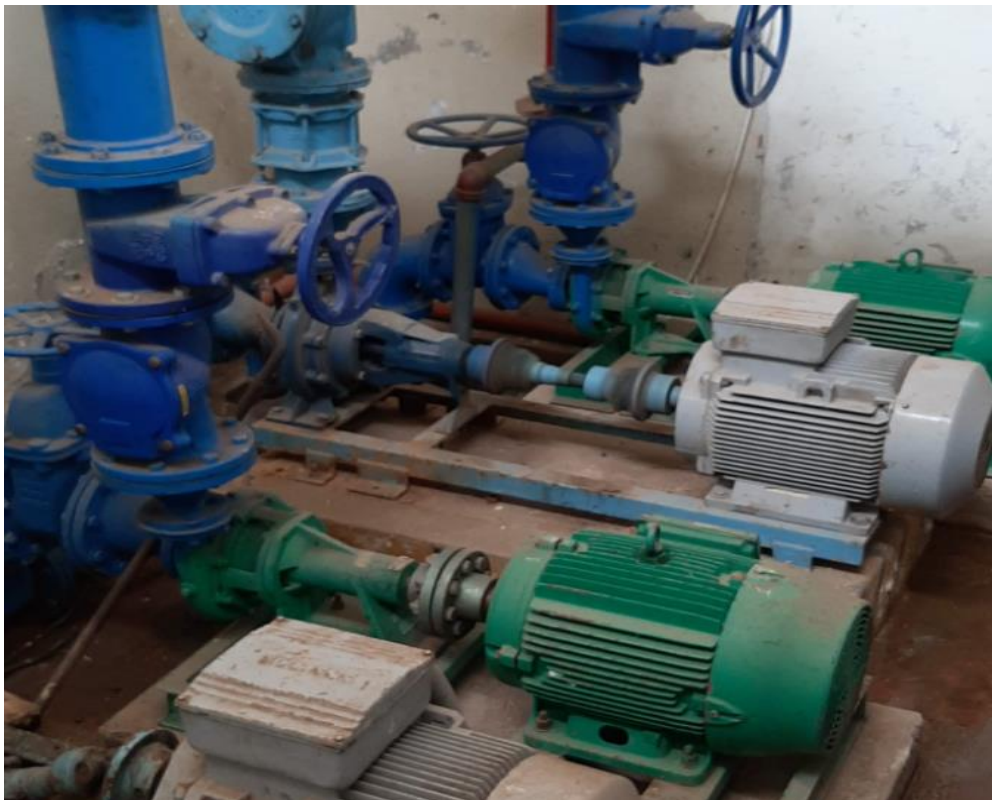
Figura 57. Estación de bombeo R-7
