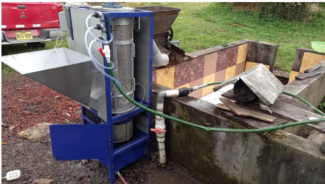
Figura 102. Instalación de la máquina lavadora de café
