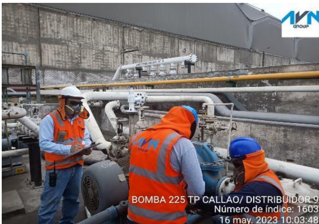
Figura 21. Supervisión del mantenimiento preventivo de motor a prueba de explosión
