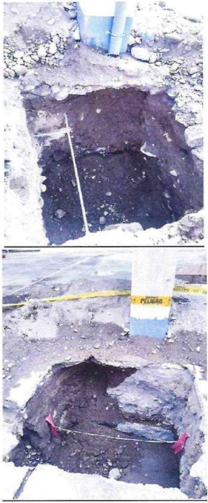
FOTOGRAFIA N° 04 Y 05: Estado actual de las excavaciones para zapatas, se observa tierra húmeda y de paredes inestables, haciendo imposible el vaciado de concreto.
