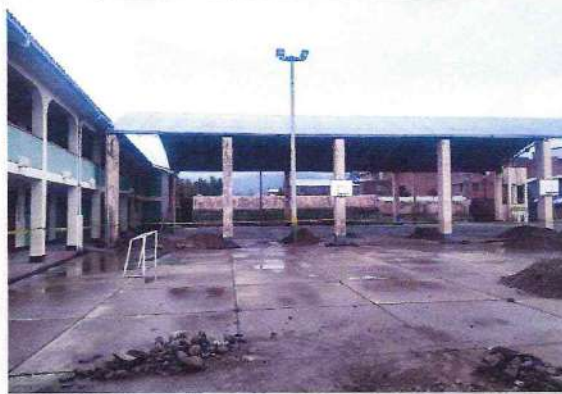
FOTOGRAFIA N° 01 Y 02: incidente en obra del día 16/02/2022 y 19/02/2022 luego de las lluvias, se puede apreciar pozos de agua.
