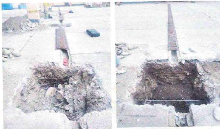
Fotografía N° 02 y 03: Se encontraron cables eléctricos expuestos además de tuberías de agua potable en el área de excavación de zapatas a una profundidad de 80 cm del NPT y 60 cm del NPT.
