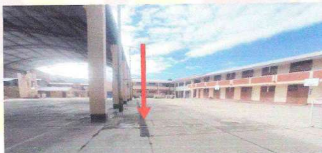
Fotografía N° 04: Se encontró una canaleta existente de red de drenaje pluvial que interfiere en la ubicación de las zapatas proyectadas.
