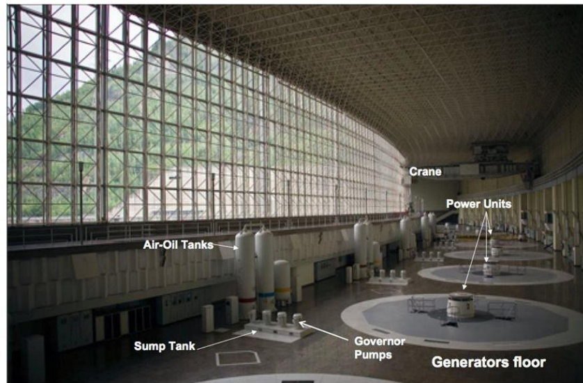
Figura 05: Vista de 10 Generadores, Grúa, tanques de aire y aceite. Fuente: Connecting Asset Management, SMRP Annual Conference, 2014
