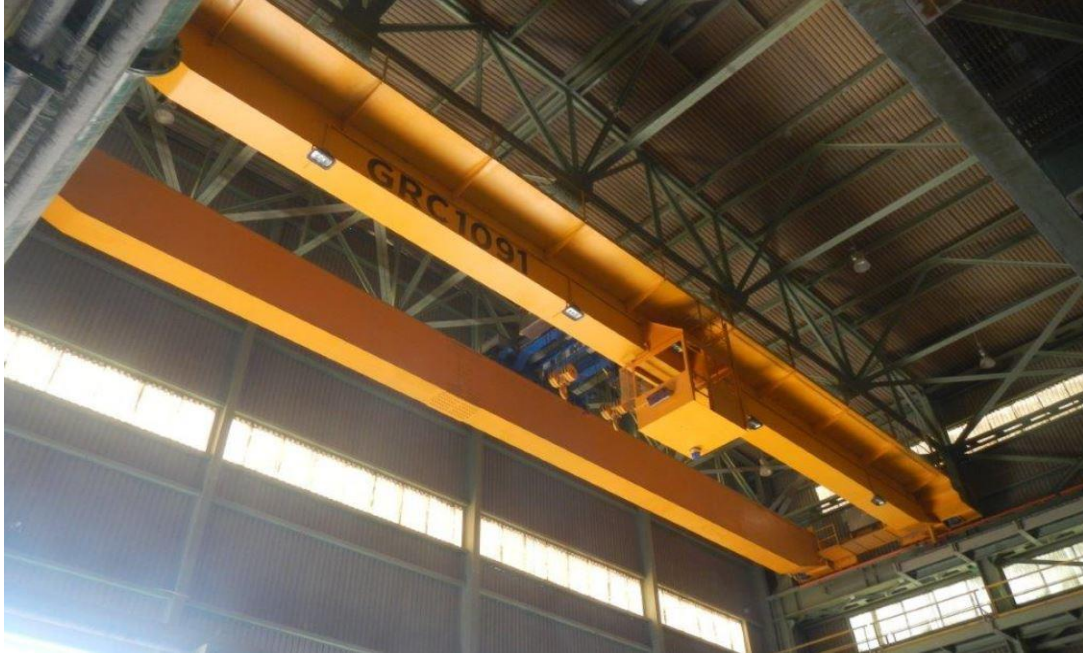
Figura 02: Punte Grúa de 35+35 toneladas. Fuente: Elaboración propia
