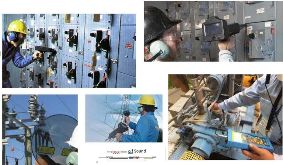
Figura 15: Inspección de Ultrasonido Equipos Eléctricos. Fuente: Best Practices in Electrical Equipment Reliability, SMRP Annual Conference, 2014.
