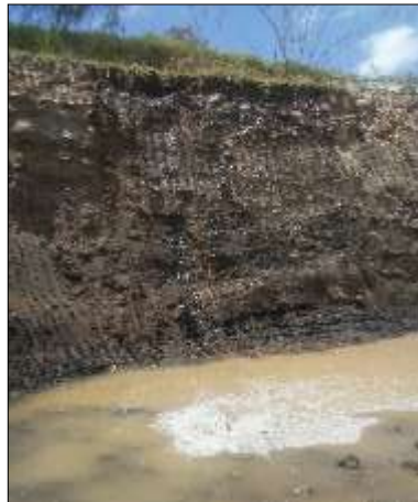
Figura 67. Filtración de agua.
