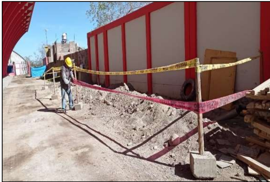
Figura 7. Señalizaciones y EPP.
