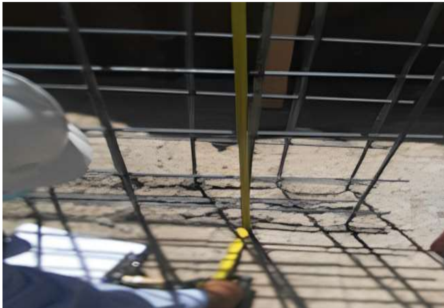
Figura 40. Verificación de medidas.
