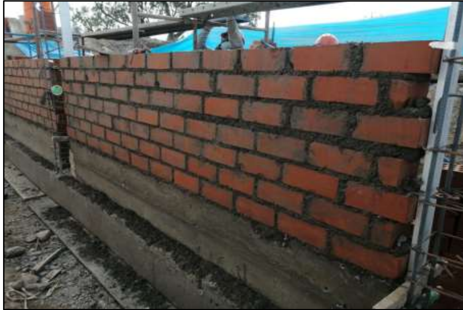
Figura 61. Asentamiento de ladrillo.
