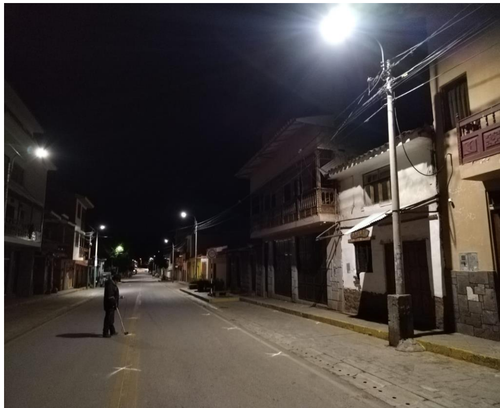
Figura 23. Medición de un alumbrado público tresbolillo de lámpara led 38W
