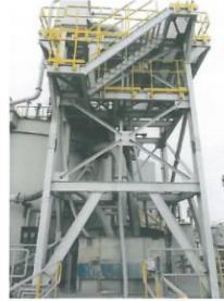
Foto 05, Estructura de muestreador montaje completo al 100%.
