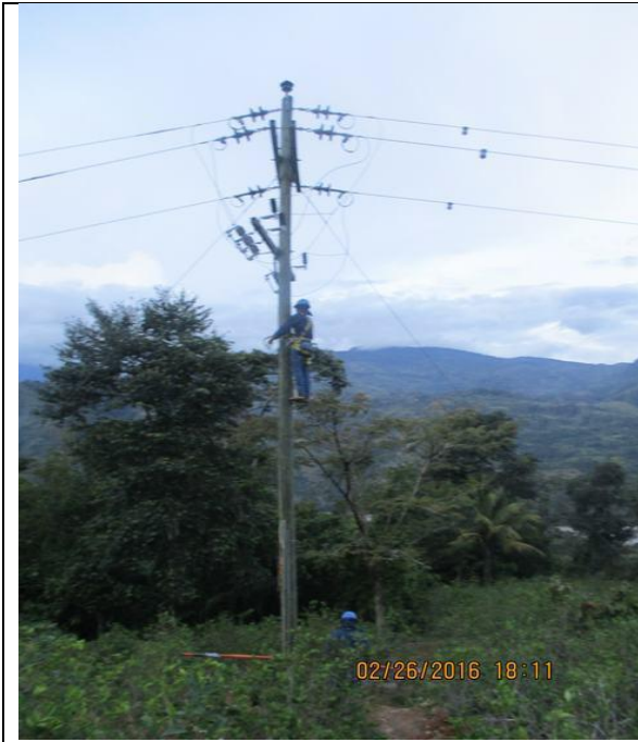
Instalación de indicadores de falla ind_002 en el alimentador A4030 servicio eléctrico San Francisco -localidad de San José
