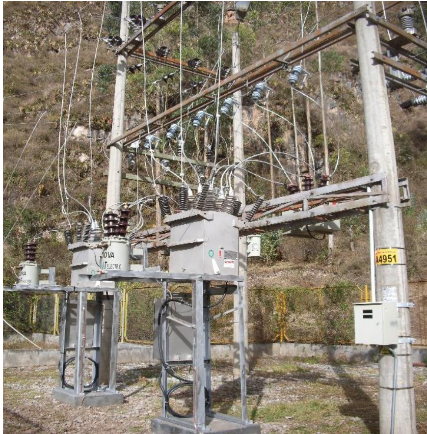
Figura 12. Recloser trifásico montado en S.E.T. Charpin con todo su equipamiento
