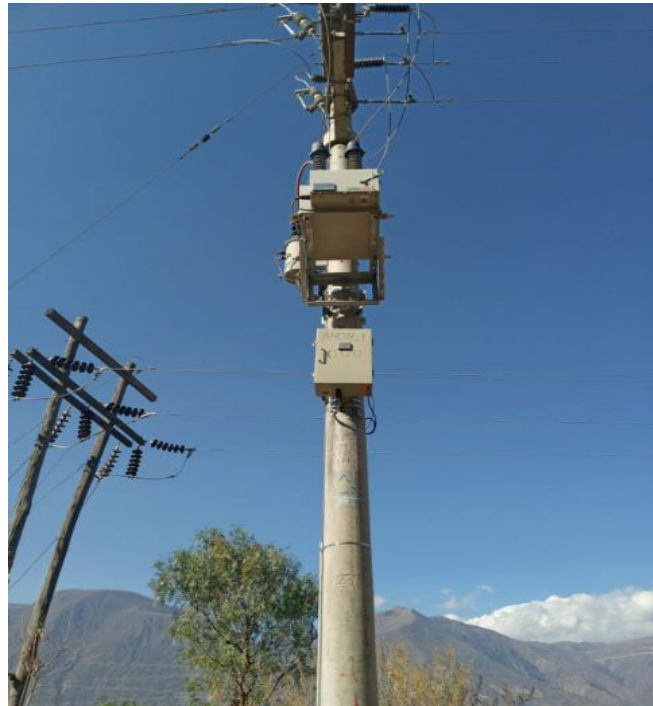
Figura 3. Alimentador A4017 -Ayacucho– recloser trifásico
