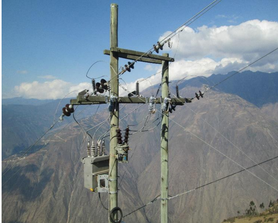
Figura 13. Recloser trifásico montado en inmediaciones en la localidad de Urpay – Salcahuasi
