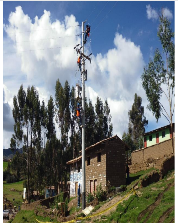
Recloser trifásico instalado en Paucará - Huancavelica norte A4113
