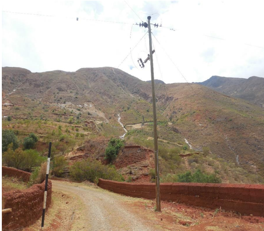
Figura 5. Seccionalizador defectuoso en derivación a Acochacan
