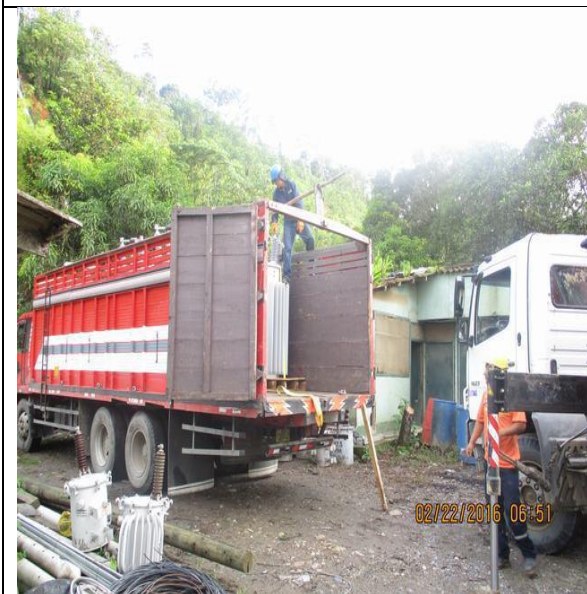
Descarguío de reguladores de tensión servicio eléctrico San Francisco – localidad de Kimbiri-minicentral San Francisco.
