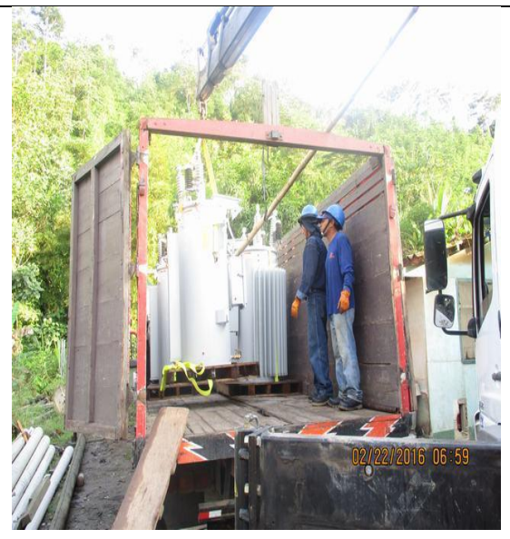
Descarguío de reguladores de tensión servicio eléctrico San Francisco – localidad de Kimbiri – minicentral San Francisco.
