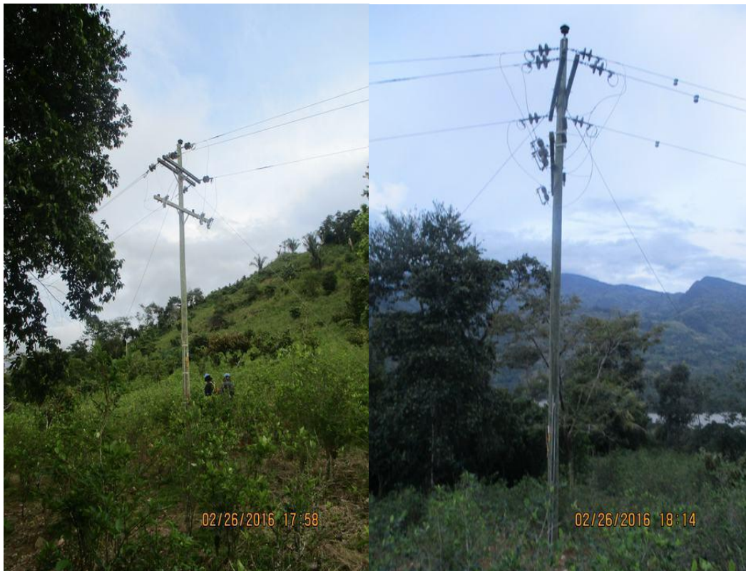
Figura 18. Comparativa antes y después del montaje de los indicadores de falla ind_002 en el alimentador A4030, subestación San Francisco, localidad de San José
