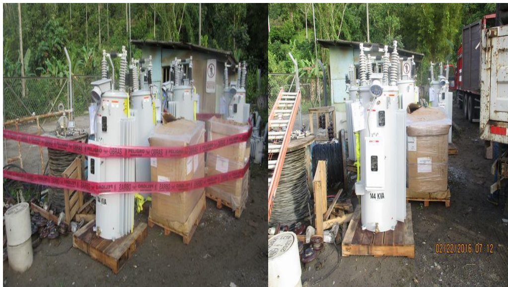
Figura 21. Descarga de reguladores de tensión, subestación San Francisco – localidad de Kimbiri minicentral San Francisco
