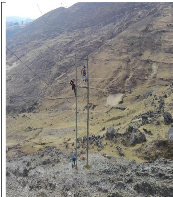
Montaje de pararrayos de línea en sistema eléctrico rural Huancavelica norte - Matipaccana
