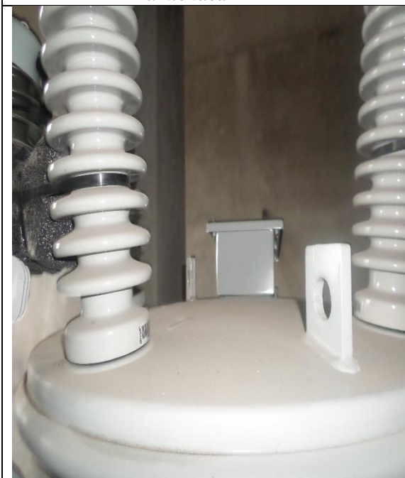
Vista de terminales del regulador de tensión instalado en SER San Francisco.
