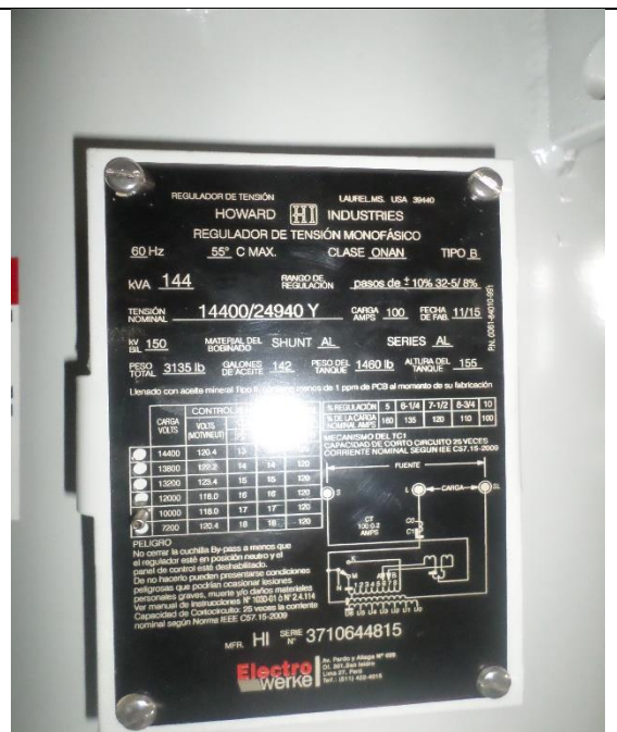
Placa de características técnicas de los reguladores de tensión instalados en SER San Francisco
