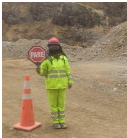
Figura 18. Fotografía del trabajador vigía en relavera A y B área de obras civiles.
