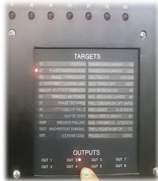
Figura 23 Baja tensión (Subtensión) señal en relé
