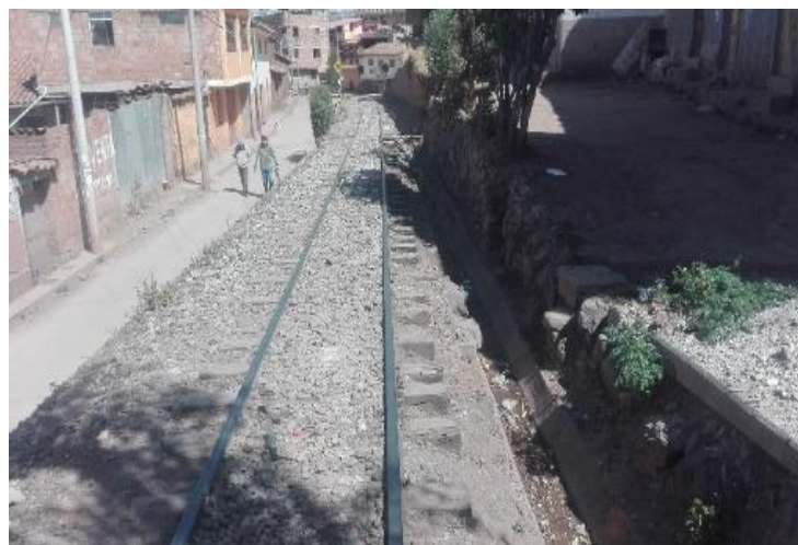
Figura 29. En el Km 3.200 del tramo Cusco - Hidroeléctrica
