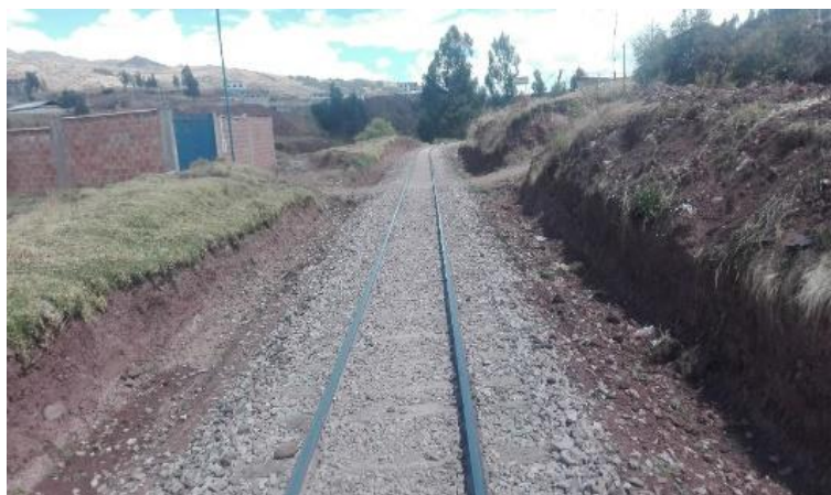
Figura 32. En el Km 17.250 del tramo Cusco- Hidroeléctrica
