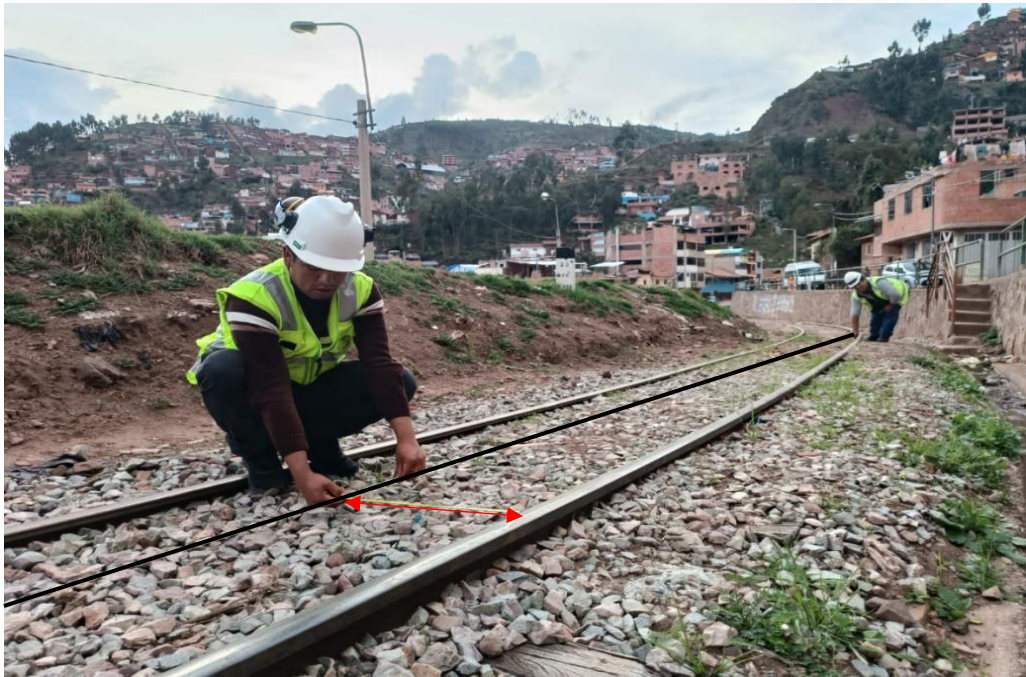
Figura 38. Medición de la Flecha en campo
