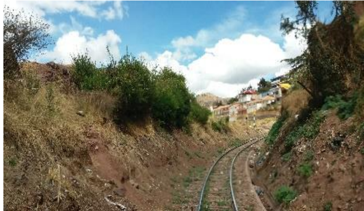
Figura 30. En el Km 6.10 del tramo Cusco- Hidroeléctrica
