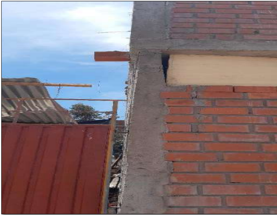
Figura 280. Deficiencia en el proceso constructivo, no tiene la uniformidad necesaria la columna.
