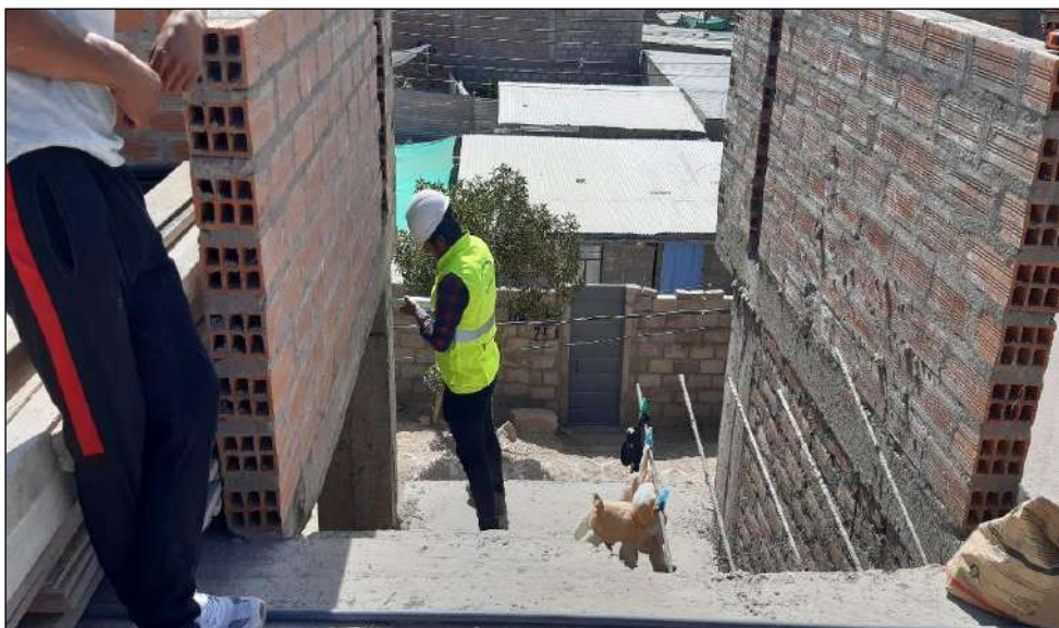
Figura 279. Falta de simetría y continuidad en elevación, el espesor de las juntas no cumple con la norma.
