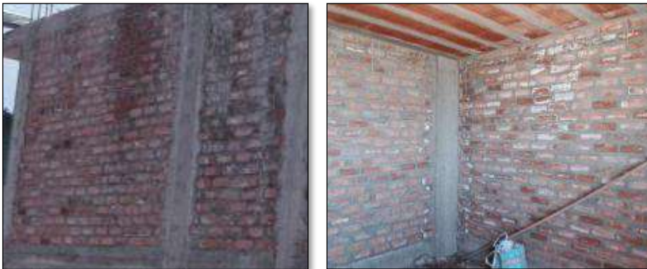
Figura 169. Muros con presencia de eflorescencia.
