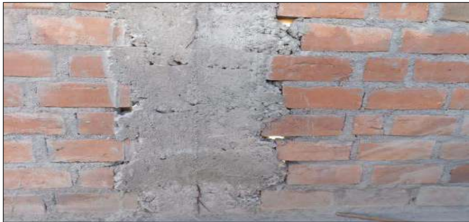
Figura 159. Presencia de cangrejas entre la unión de muros y columnas.
