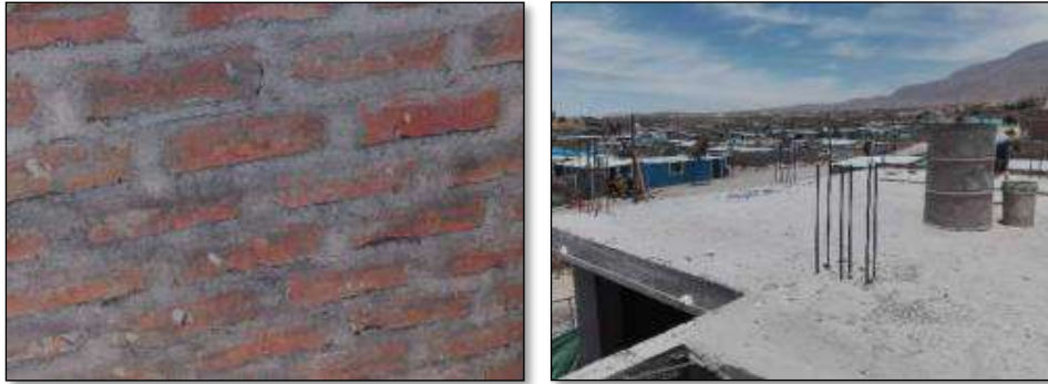
Figura 176. Unidad de albañilería sólida artesanal y acero de refuerzo expuesto.
