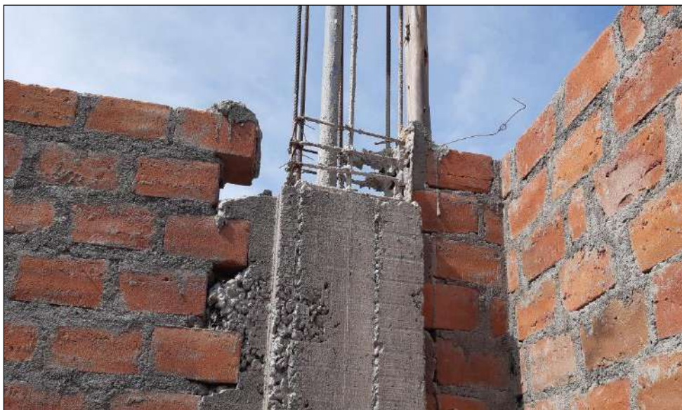
Figura 281. Mala unión entre el muro portante y la columna la norma nos indica máximo 5 cm. De la misma forma se observa que la tubería de un montante está dentro de la columna, el cual no es conveniente colocar por que, debido a la disminución del área resistente, lo que podría ocasionar su rotura.
