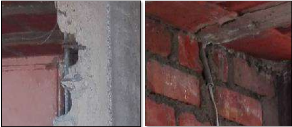
Figura 163. Acero de refuerzo expuesto y tubería de instalaciones eléctricas.
