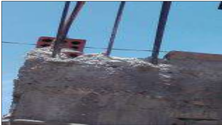
Figura 155. El acero de refuerzo en la columna está expuesto.
