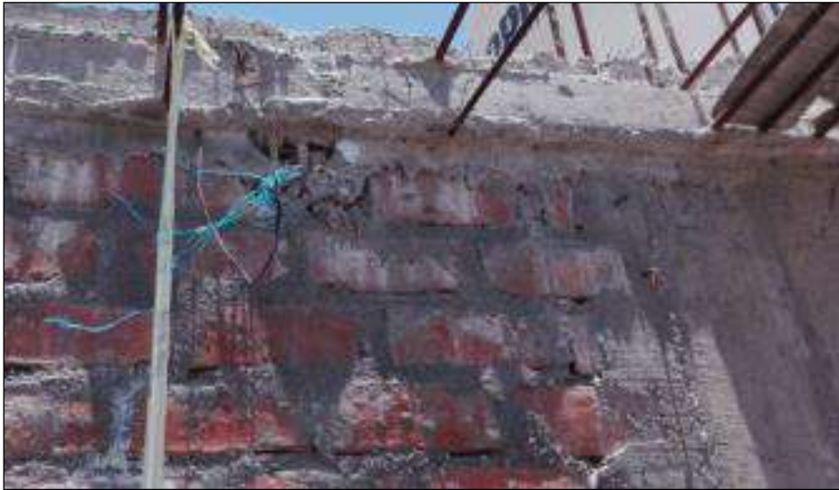
Figura 172. El acero está expuesto y la unidad de albañilería es sólida industrial.
