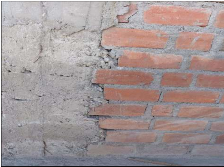
Figura 144. Presencia de cangrejas entre la unión de muros y columnas.
