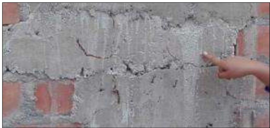
Figura 181. Presencia de cangrejas entre la unión de vigas y columnas.
