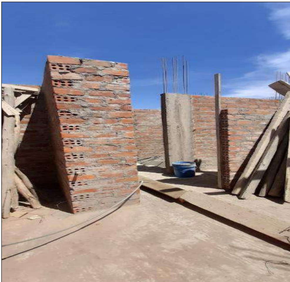
Figura 282. Descripción: se observa un mal proceso constructivo, juntas verticales y juntas horizontales observadas, lo cual no garantizara un buen amarre de los ladrillos.
