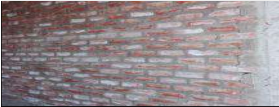
Figura 188. Muros con presencia de eflorescencia severa.
