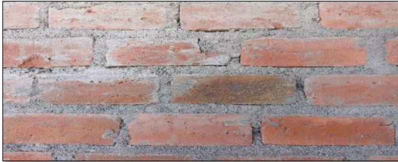
Figura 140. Espesor de las juntas y unidad de albañilería solida artesanal.
