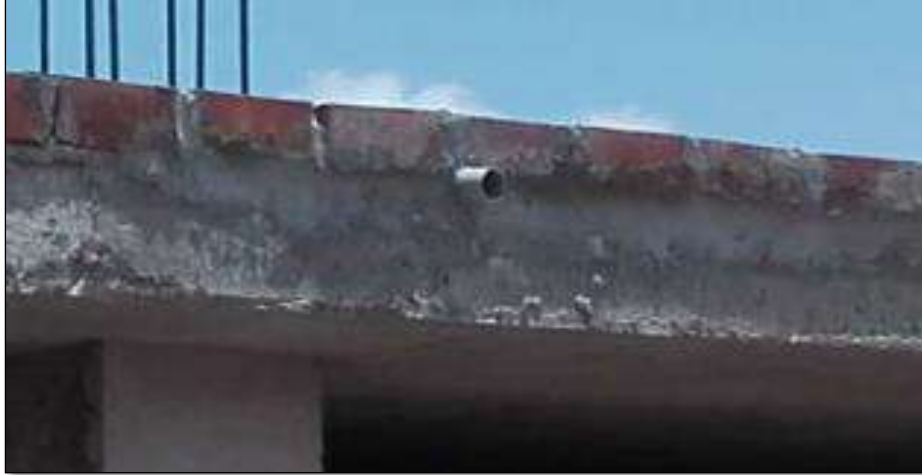
Figura 178. Vivienda que no cuenta con un drenaje pluvial adecuado.
