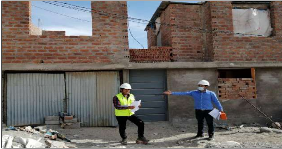
Figura 179. Vivienda analizada N° 12 en la Asociación Apipa Sector XV, distrito de Cerro Colorado.
