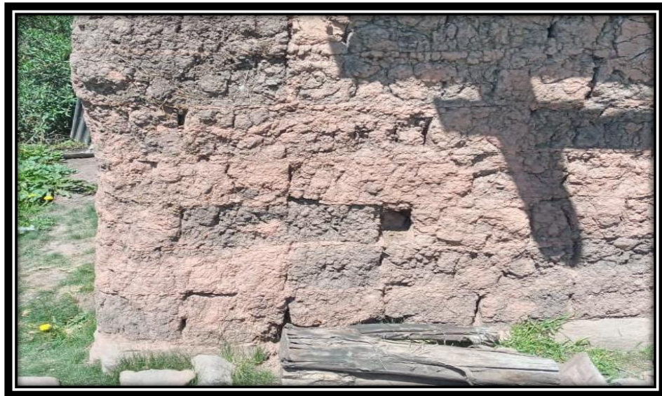
Figura 3. Pared donde el adobe ha sido desgastado por la erosión.
