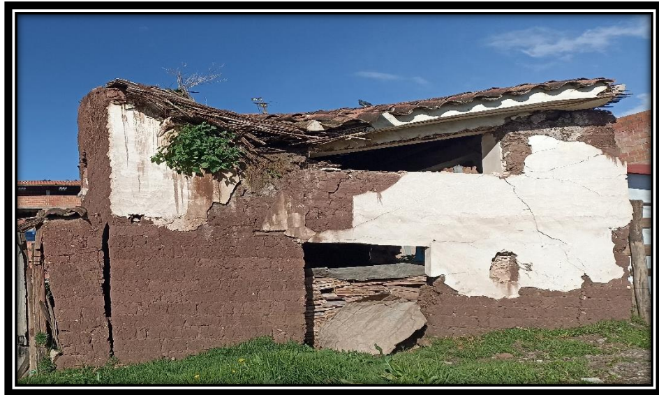
Figura 1. Vivienda con fallas del adobe, como rajaduras, erosión por humedad y posterior colapso.
