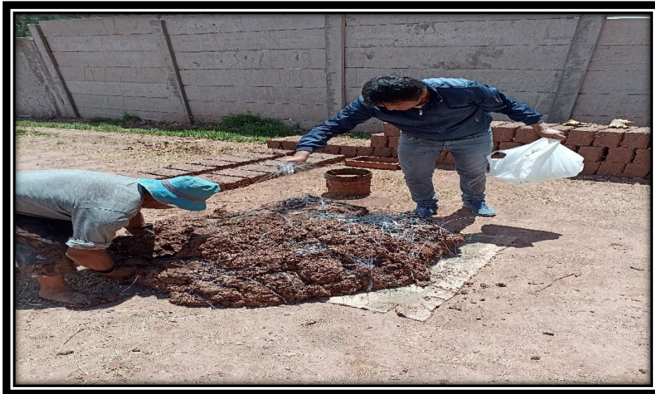
Figura 44. Dosificación con el 3 % de tiras de PET.
