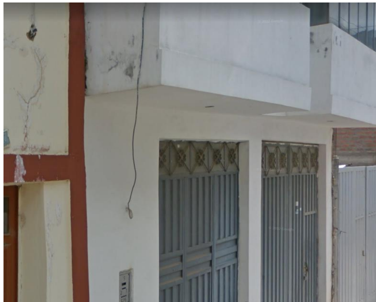
Figura 1.1 Concreto expuesto por fisuras. Fuente: Autor.
