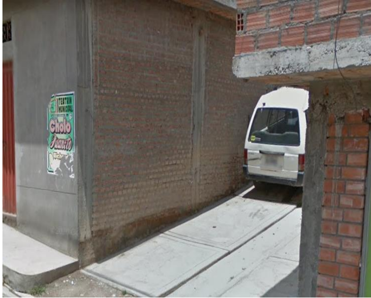
Figura 1.2 Fisuras en concreto. Fuente: Autor.
