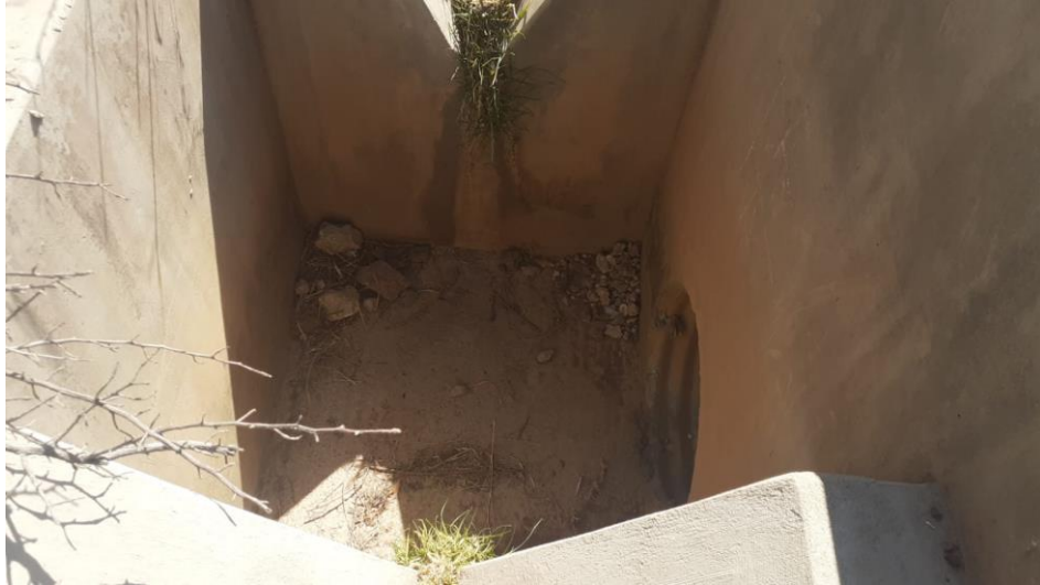
Fotografía 15. Vista de la entrada en la alcantarilla N°03, julio de 2023. Nota: Elaboración propia.
