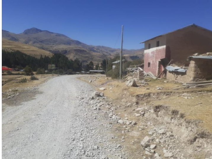
Fotografía 11. Trocha sin cuneta, Progresiva 1+523, julio de 2023.
