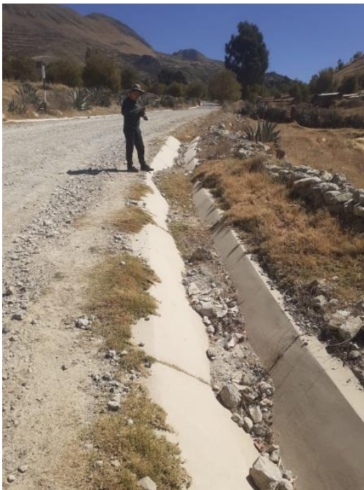
Fotografía 8. Progresiva 0+883, en la que se puede colmatación en la cuneta, julio de 2023. Nota: Elaboración propia.
