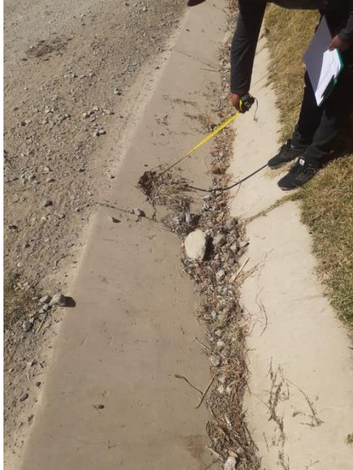
Fotografía 7. Erosión en cuneta en la progresiva 0+615, julio de 2023. Nota: Elaboración propia.
