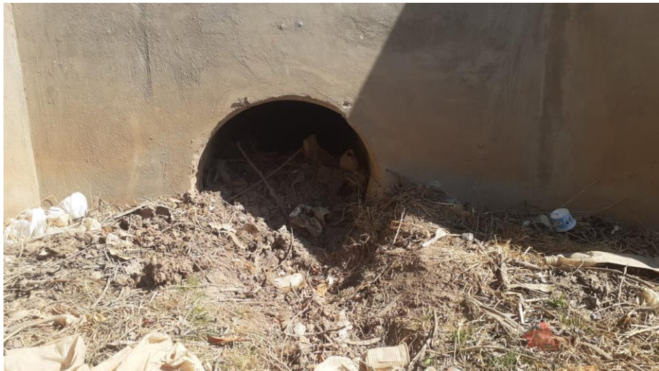
Fotografía 16. Vista de la salida en la alcantarilla N°03, julio de 2023. Nota: Elaboración propia.
