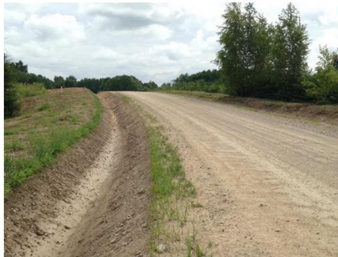
Figura 2. Vista de una cuneta sin revestimiento. Nota: Elaboración propia.
