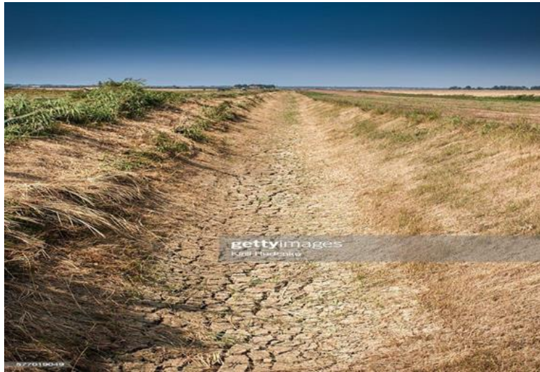
Figura 3. Erosión de cunetas. Nota: Elaboración propia.
