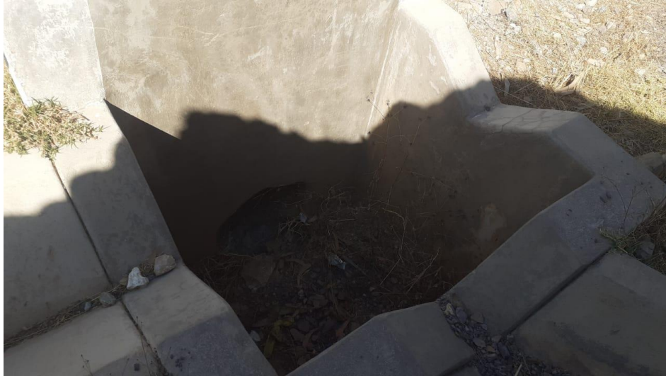
Fotografía 13. Vista de la entrada en la alcantarilla N°02, julio de 2023. Nota: Elaboración propia.
