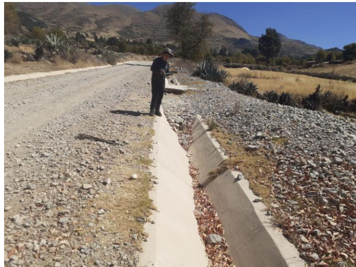
Fotografía 10. Progresiva 1+064, en la que se observa la colmatación total de la sección de la cuneta, julio de 2023.
