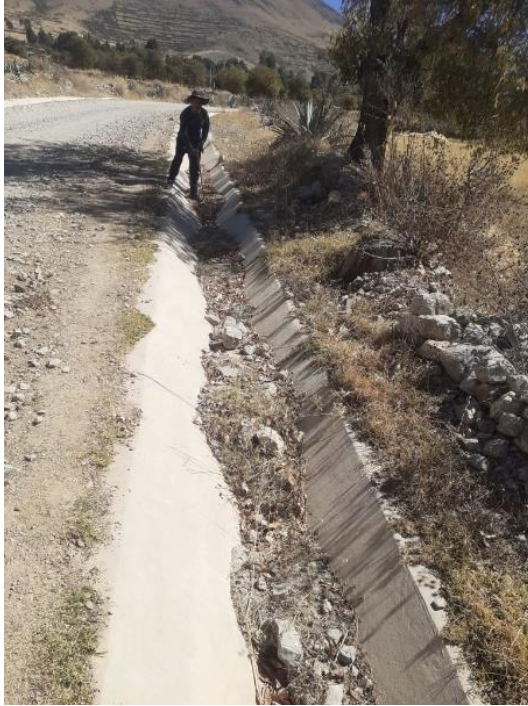
Fotografía 9. Progresiva 1+117, en la que se observa la colmatación parcial, julio de 2023.
