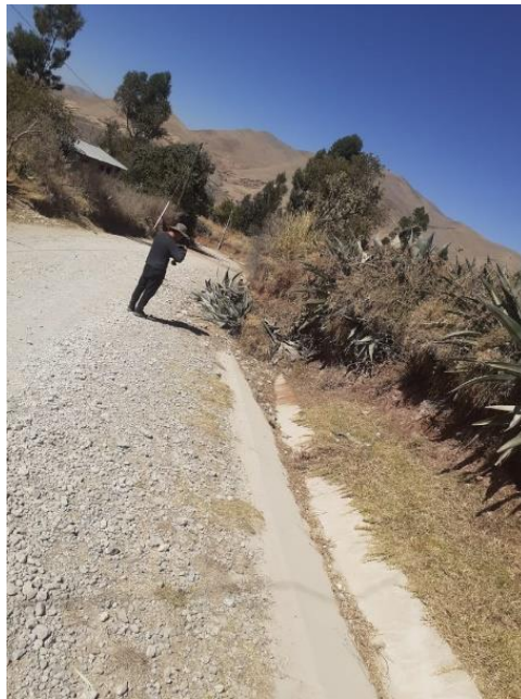
Fotografía 4. Progresiva 0+300, en la que se puede observar la colmatación por derrumbe, julio de 2023.
