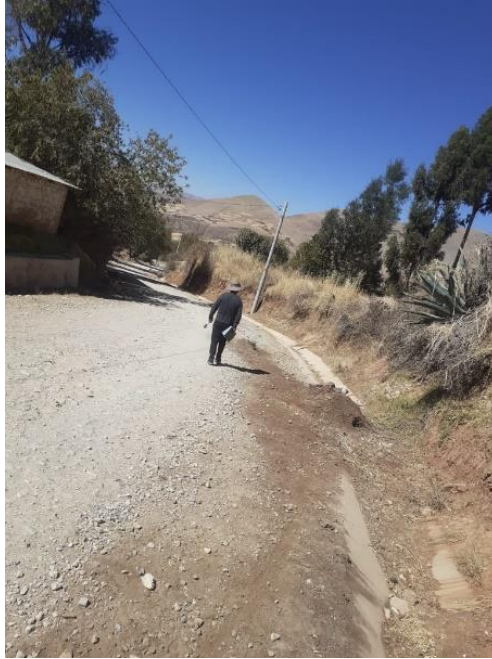
Fotografía 5. Progresiva 0+450, colmatación de cuneta en un tramo de 20 m., julio de 2023. Nota: Elaboración propia.
