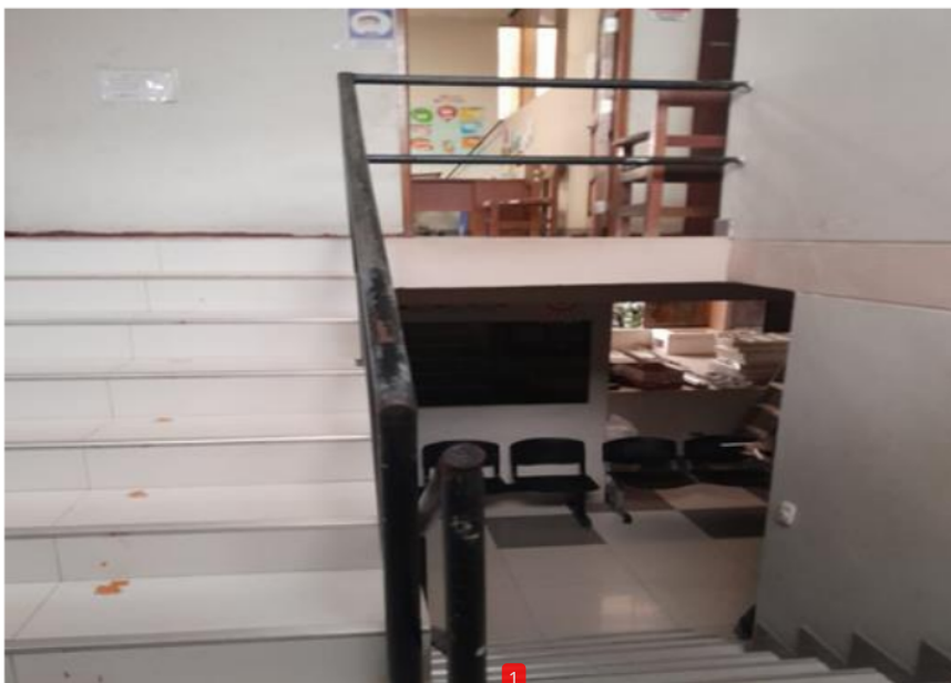
Figura 6. Instalaciones de la 1 oficina anexa de la Municipalidad Distrital de Kimbiri. Nota. Evidencia extraída de las instalaciones de la Municipalidad Distrital de Kimbiri de la oficina de anexa, en la cual se evidencia la falta de rampas para personas discapacitadas.
