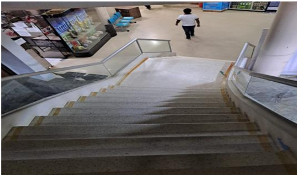
Figura 5. Instalaciones de la sede central de la Municipalidad Distrital de Kimbiri. Nota. Evidencia extraída de las instalaciones de la Municipalidad Distrital de Kimbiri, de la sede principal, en la cual se muestra la falta de rampas para personas discapacitadas.
