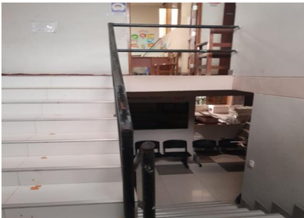
Figura 6. Instalaciones de la oficina anexa de la Municipalidad Distrital de Kimbiri. Nota. Evidencia extraída de las instalaciones de la Municipalidad Distrital de Kimbiri de la oficina de anexa, en la cual se evidencia la falta de rampas para personas discapacitadas.
