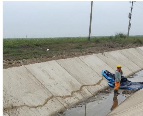
Figura 2 concreto fisurado por deficiencias de concreto
