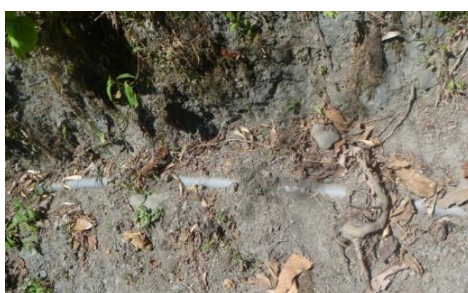
Figuras 12. Tubería expuesta
