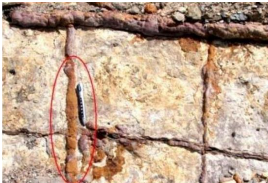
Figura 12. Discontinuidades con material de relleno de óxido de hierro (5)
