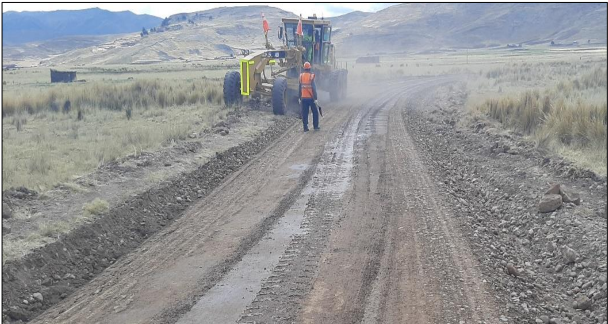
Fotografía 3. Vista de los trabajos de perfilado de la vía sin aporte de material, Emp. PE-34H – Chamacani.
