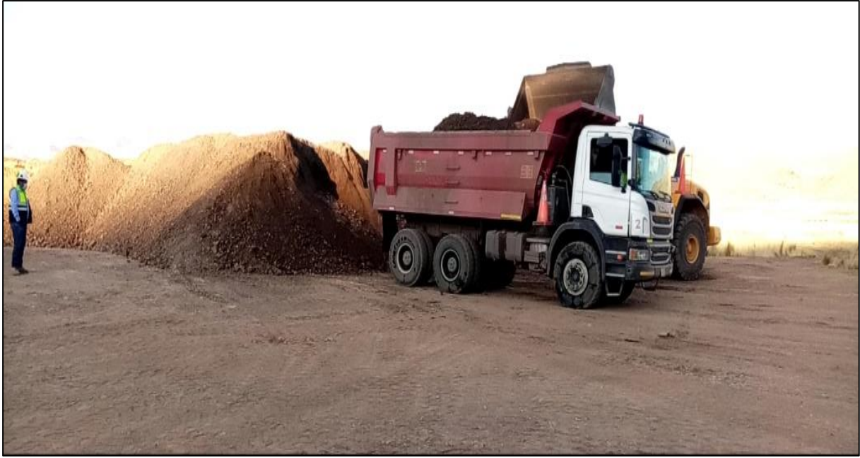
Fotografía 7. Vista del traslado de material de cantera en la vía Emp. PU-827 - C.E. Santa Rosa de Uyuni.
