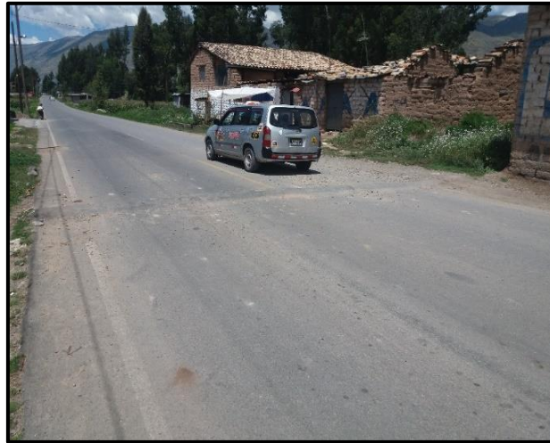
Figura 28. Fallas de la vía en la progresiva 9+362.24
