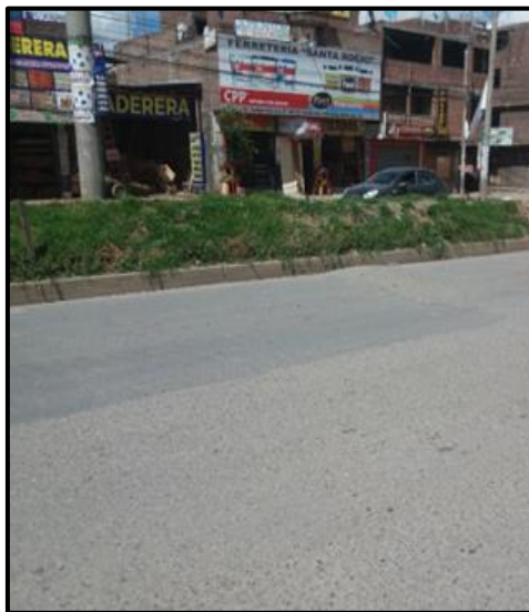
Figura 5. Fallas de la vía en la progresiva 0+664.23
