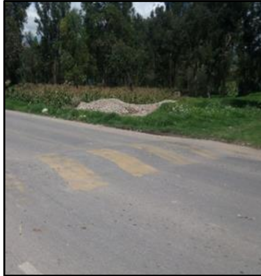
Figura 30. Fallas de la vía en la progresiva 6+052.10
