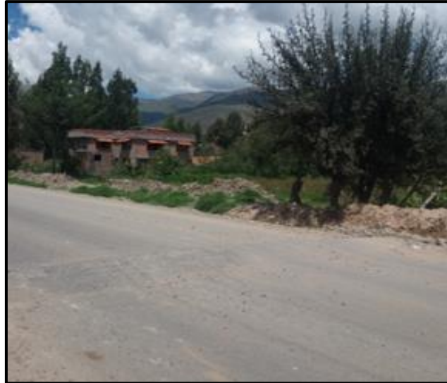
Figura 22. Fallas de la vía en la progresiva 9+194.81
