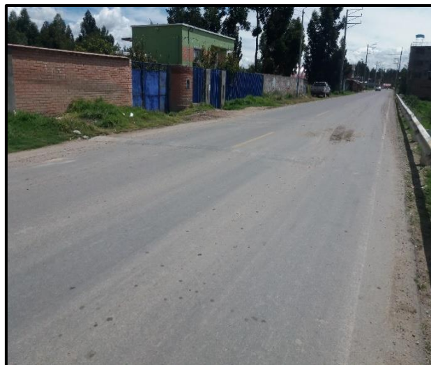
Figura 27. Fallas de la vía en la progresiva 8+804.65
