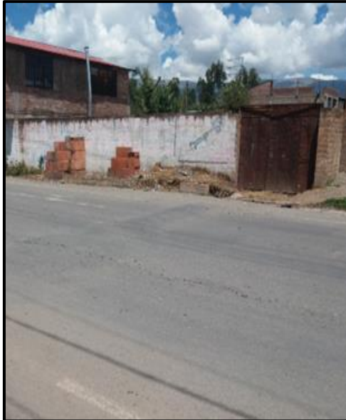
Figura 12. Fallas de la vía en la progresiva 4+255.65
