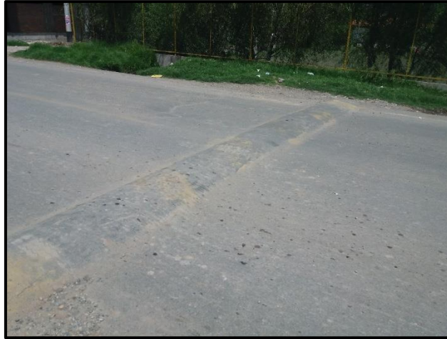
Figura 26. Fallas de la vía en la progresiva 4+897.96
