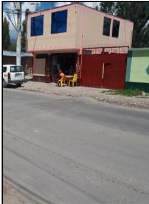
Figura 9. Fallas de la vía en la progresiva 3+361.69
