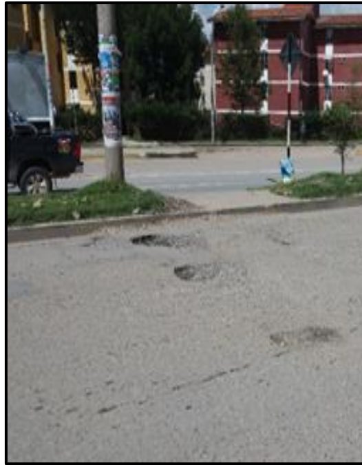
Figura 32. Fallas de la vía en la progresiva 0+136.54
