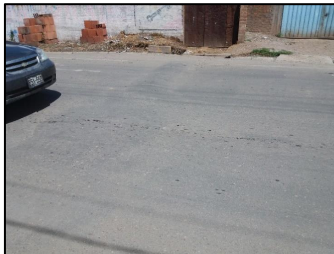
Figura 25. Fallas de la vía en la progresiva 4+255.65
