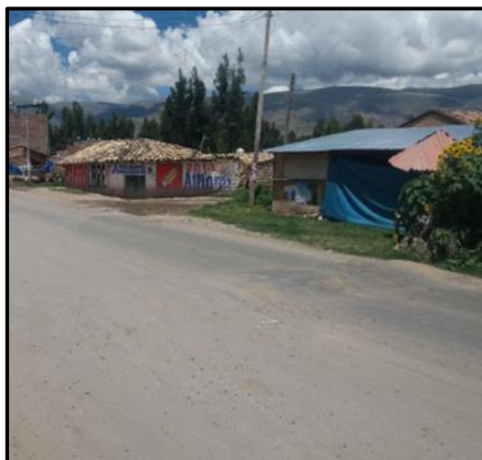
Figura 15. Fallas de la vía en la progresiva 6+631.43
