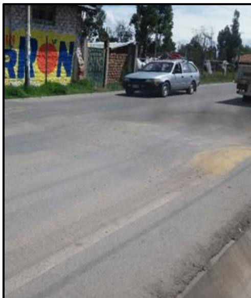
Figura 35. Fallas de la vía en la progresiva 3+841.71
