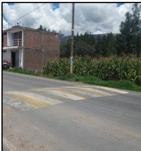
Figura 19. Fallas de la vía en la progresiva 8+095.66
