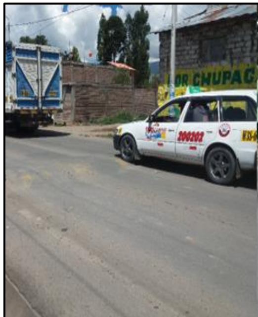
Figura 11. Fallas de la vía en la progresiva 3+841.71
