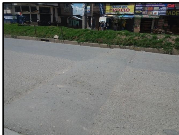
Figura 33. Fallas de la vía en la progresiva 0+664.23
