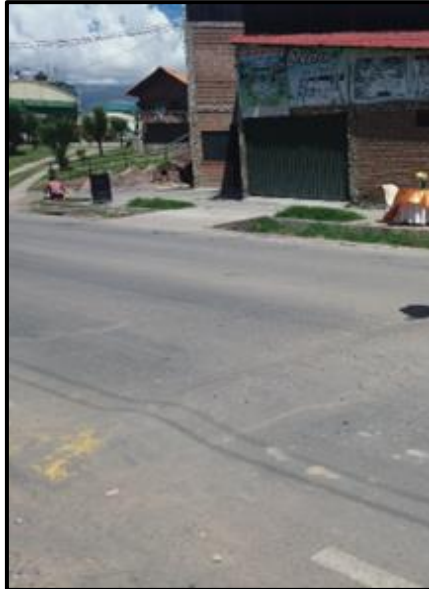
Figura 6. Fallas de la vía en la progresiva 2+256.74
