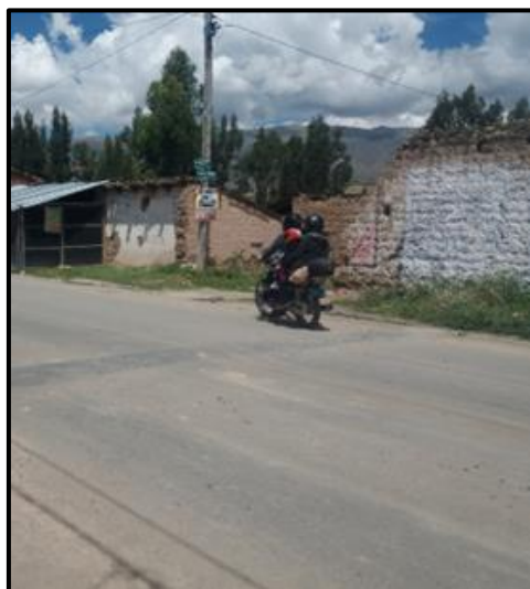
Figura 17. Fallas de la vía en la progresiva 6+861.16
