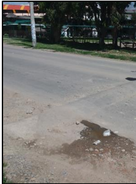
Figura 7. Fallas de la vía en la progresiva 2+638.19
