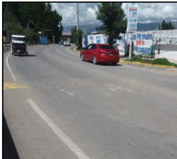
Figura 29. Fallas de la vía en la progresiva 2+084.57
