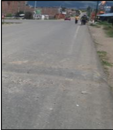
Figura 14. Fallas de la vía en la progresiva 4+786.96
