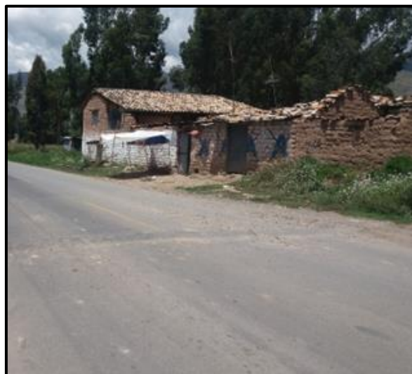
Figura 23. Fallas de la vía en la progresiva 9+362.24
