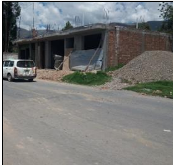
Figura 24. Fallas de la vía en la progresiva 9+650.10
