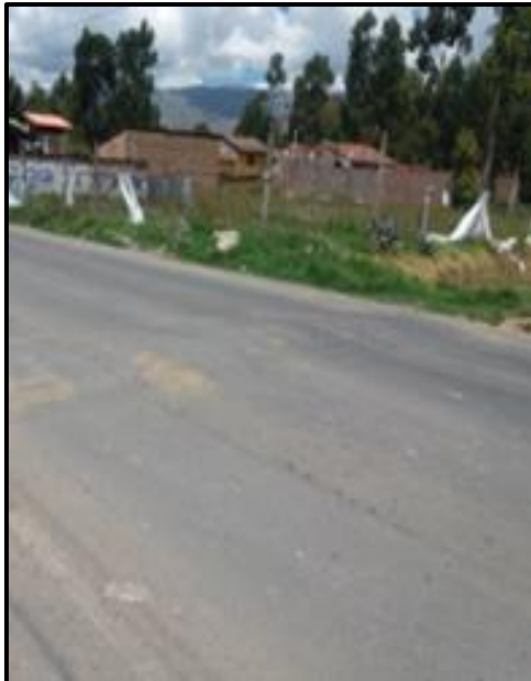
Figura 10. Fallas de la vía en la progresiva 3+794.30
