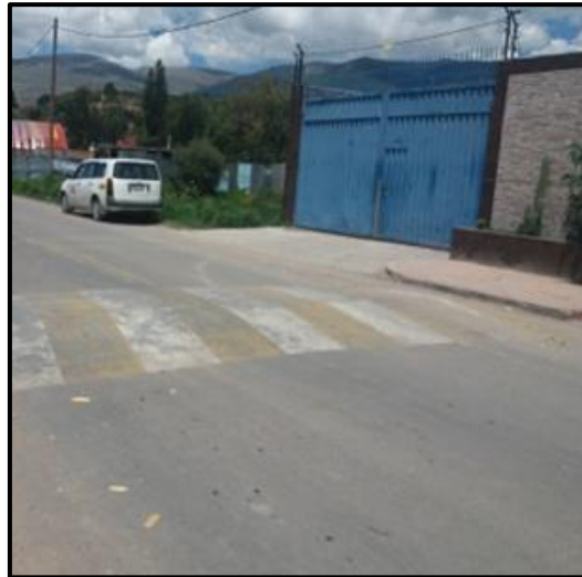
Figura 20. Fallas de la vía en la progresiva 8+534.92
