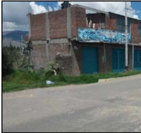
Figura 36. Fallas de la vía en la progresiva 4+786.96
