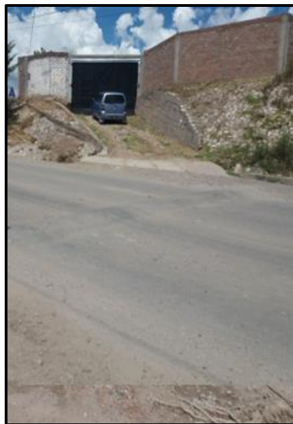
Figura 8. Fallas de la vía en la progresiva 2+812.69
