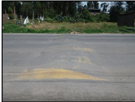
Figura 34. Fallas de la vía en la progresiva 3+794.30
