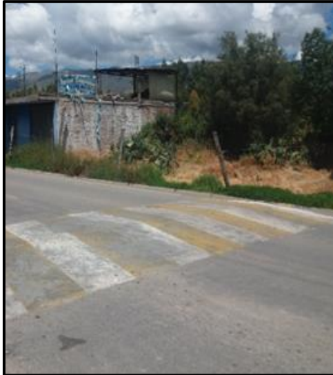
Figura 18. Fallas de la vía en la progresiva 7+328.31
