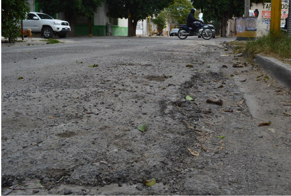
Figura 1. Pavimento asfáltico desgastado en un muy mal estado. PCI Fuente: Desarrollo de obras públicas, pavimento en mal estado
