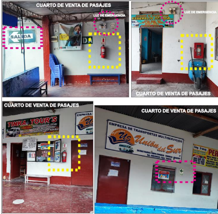
Gráfico 11. Señalización (extintores y luces de emergencia).
