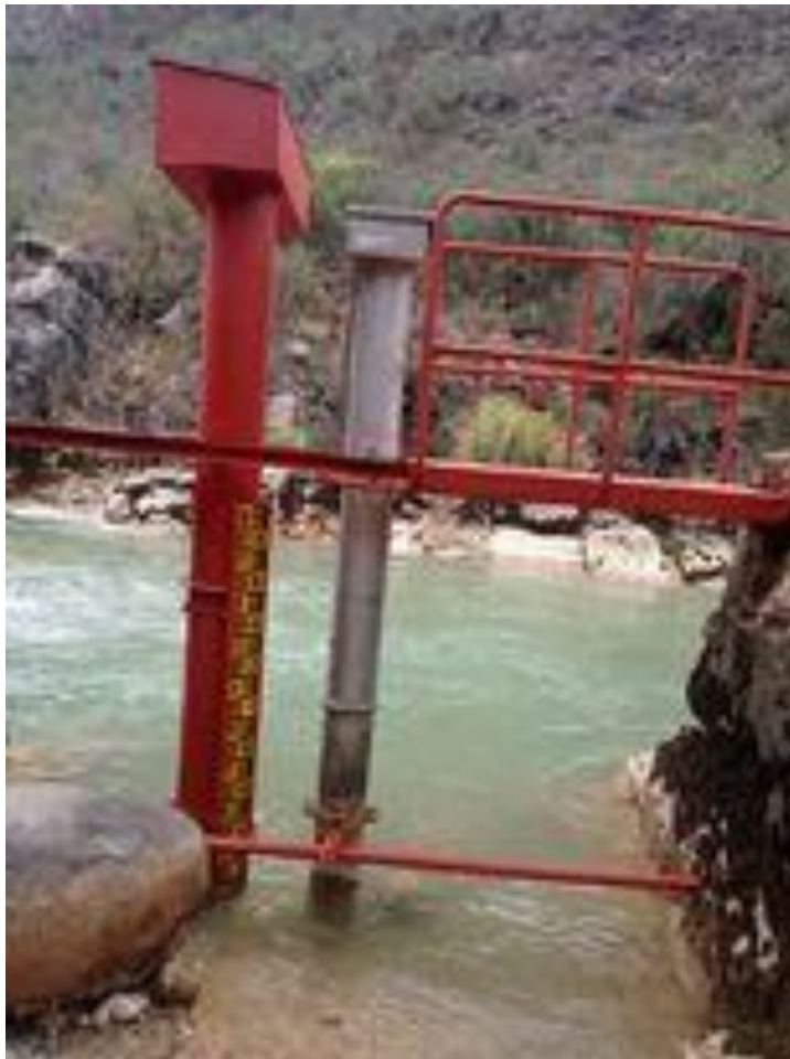
Fotografía N° 04. Estación hidrométrica Quillón, operada por Electroperú S. A.
