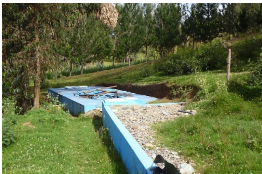
Ilustración 4: Poza de adecuación y sistema de filtro de la JASS Cullpa Alta
