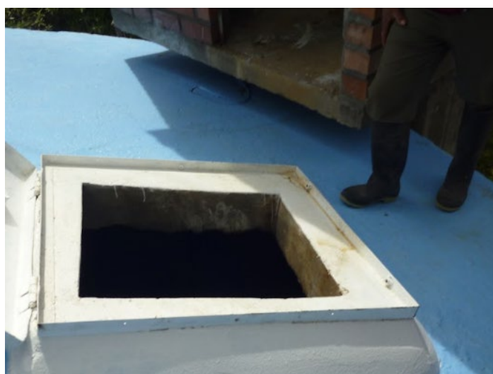
Ilustración 9: Revisión del proceso de cloración por goteo
