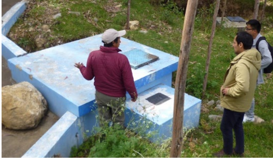
Ilustración 5: Entrada de agua al Sistema (Captación) de la JASS Cullpa Alta
