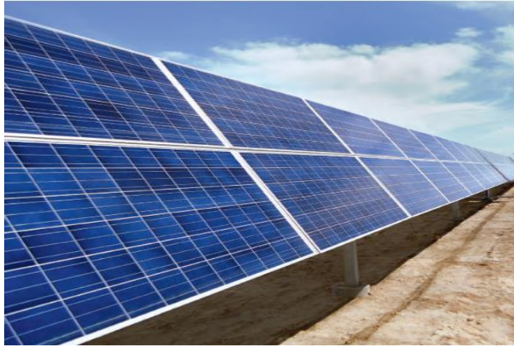
Figura 2. Paneles solares fotovoltaicos
