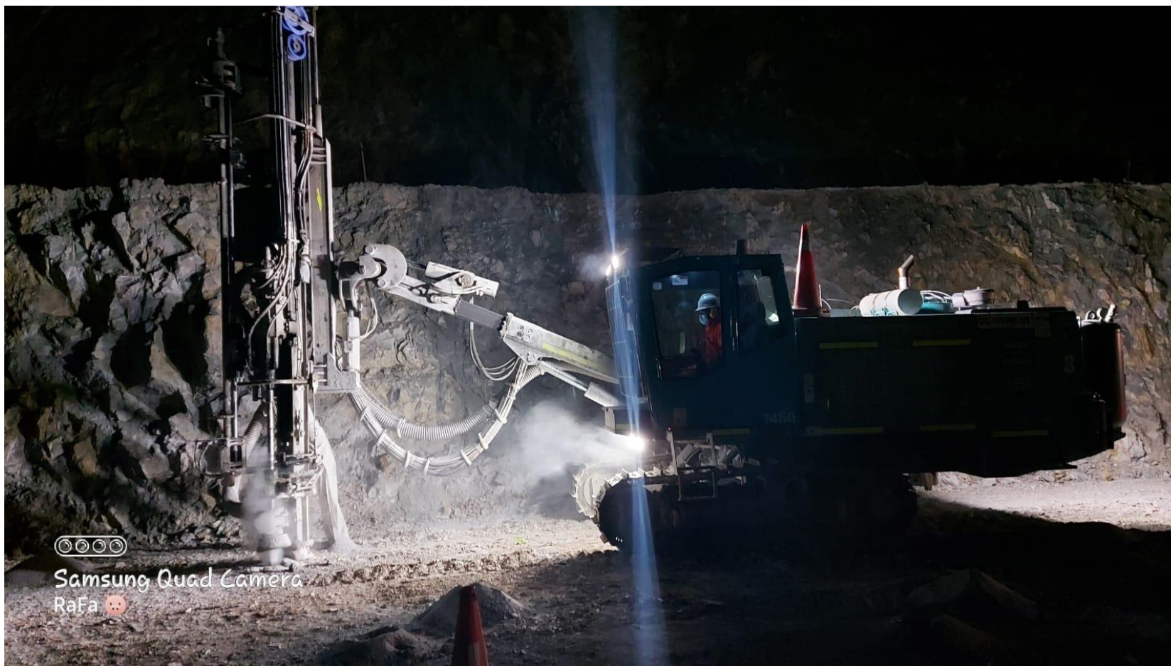
Foto tomada a perforadora Everdigm T-5 en Operaciones TN mina Paragsha-Cerro de Pasco
