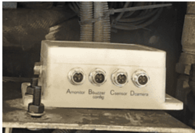
Figura 17. Ubicación de la caja de control.
