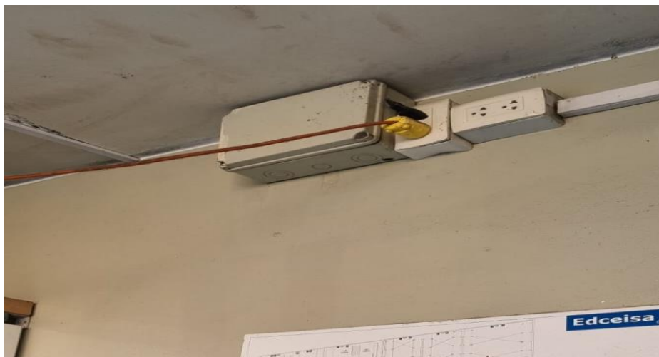
Punto de red y eléctrico
