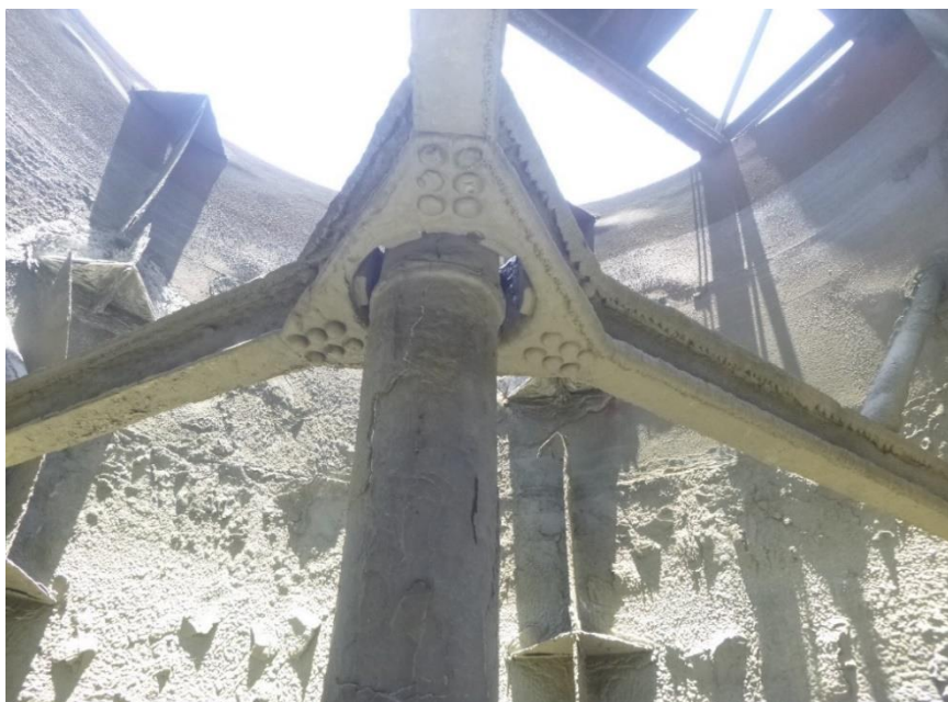
FIGURA 9: Deflectores corroídos y deteriorados
