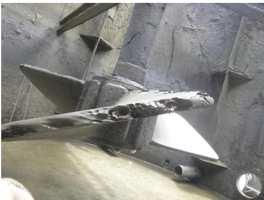
FIGURA 11: Sistema de agitación visiblemente en mal estado.
