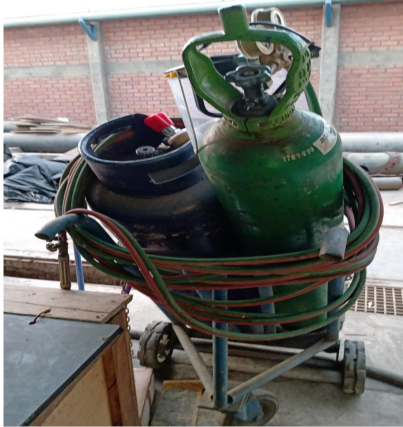
Figura 33. Transporte correcto de cilindros de gas – Budge S. A. C.
