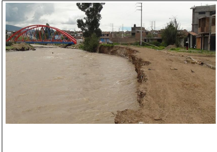
Figura 13. Infraestructuras expuestas y susceptibles ante un peligro de origen natural.
