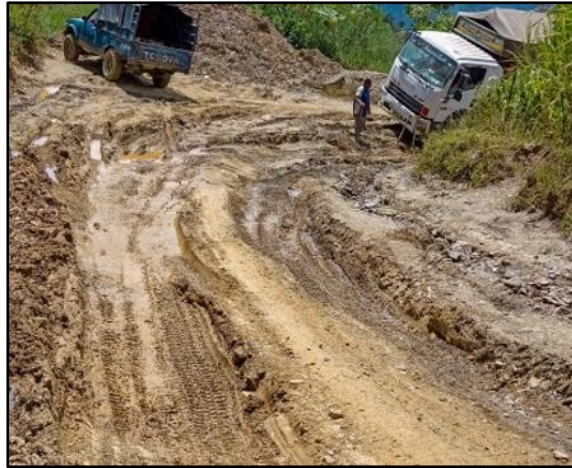
Figura 3. Estructura de la carretera en deterioro y fallas en la vía Utcubamba.
