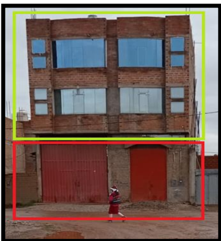
Figura 44: Existencia de Piso Blando
