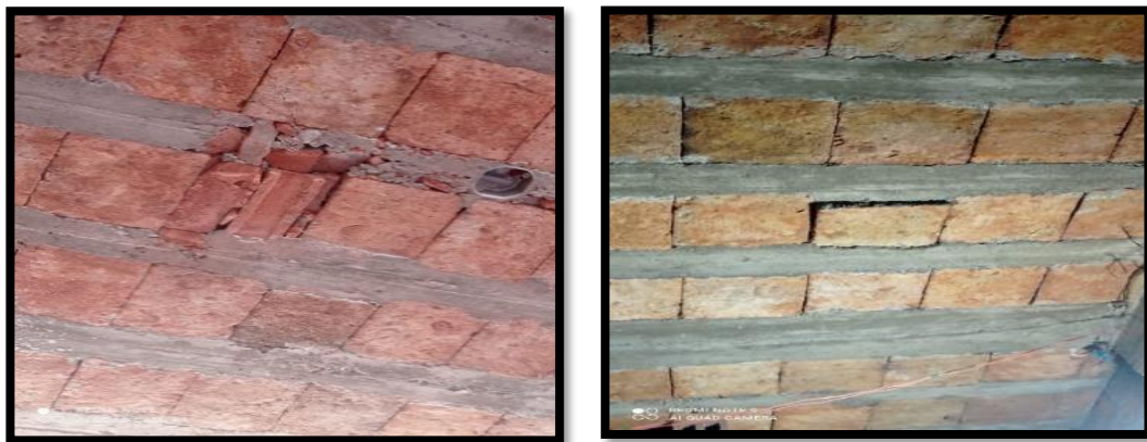
Figura 54: Vigueta reducida y ladrillo cayéndose
