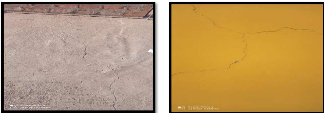
Figura 50: Fisuras en Losa Aligerada y Muros
