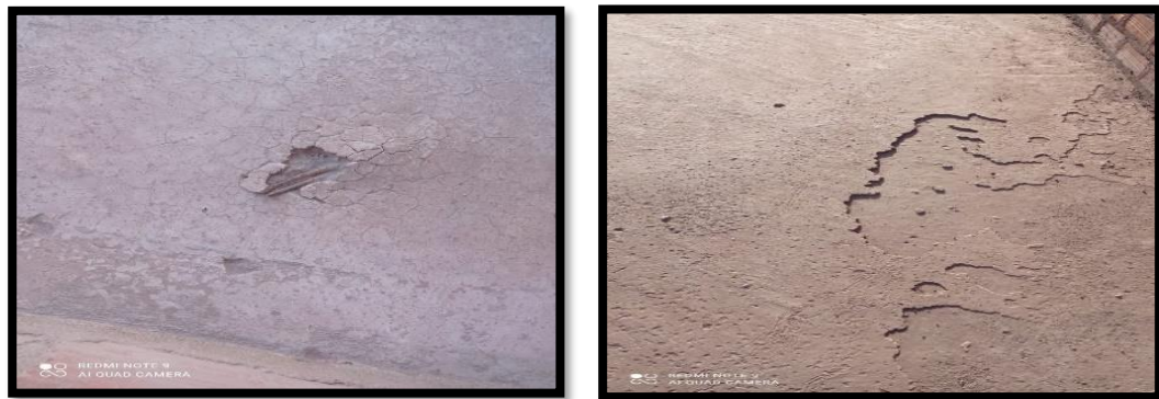
Figura 52: Acero de temperatura Expuesto y Delaminación en el techo
