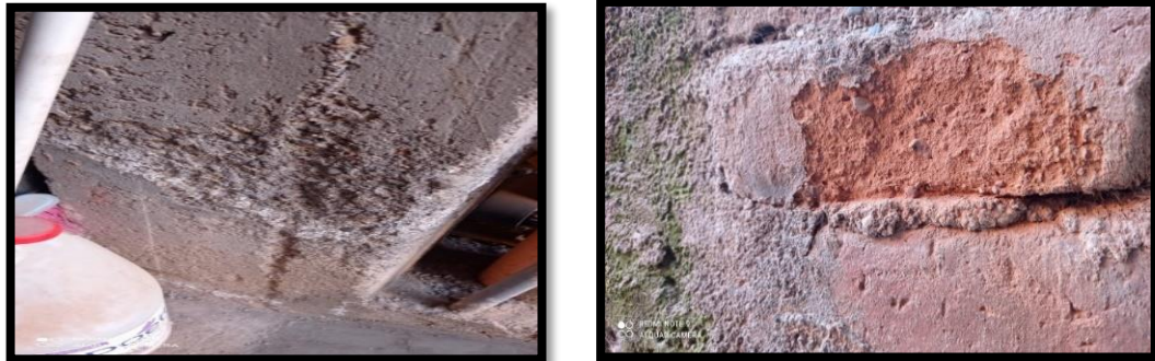
Figura 51: Carbonatación en Columna y Desintegración en la Unidad de Albañilería
