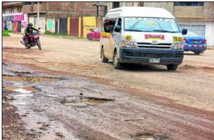
Figura 2. Cemento asfáltico deteriorado en Huancayo. Tomado de <<Pistas en Huancayo son dolor de cabeza para transportistas>>, por Diario Correo, 2015.
