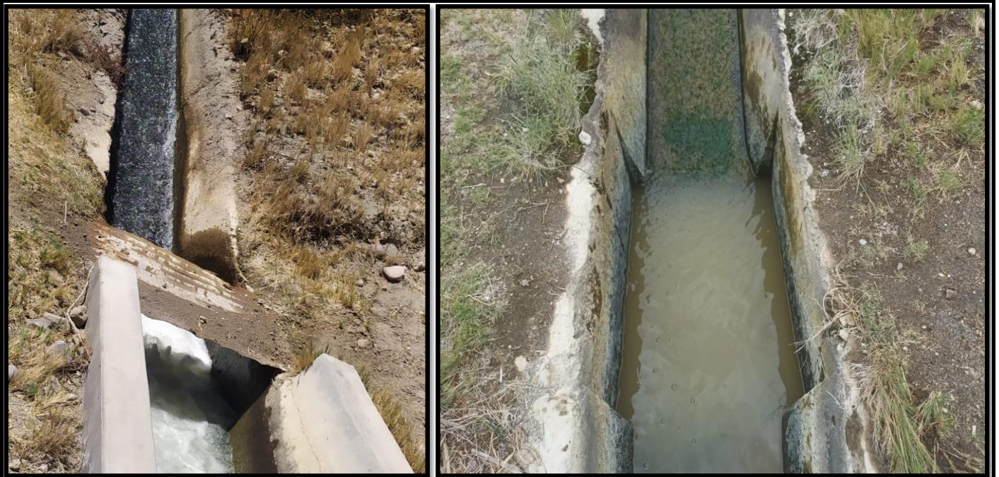
PROGRESIVA 04+230 EROSION DE MUROS DE POSA DISIPADORA
