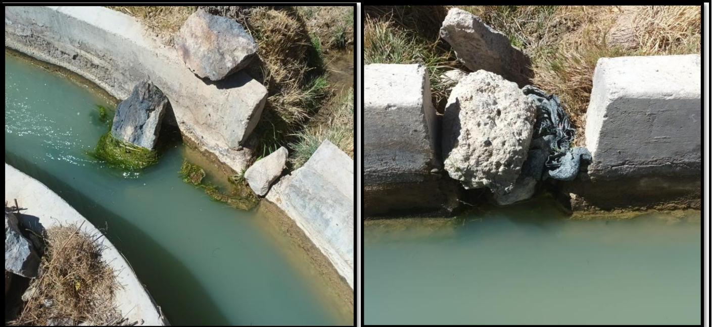
TOMAS LATERALES IMPROVISADAS EN LAS PROGRESIVAS 04 + 485 Y PROGRESIVA 04 + 545
