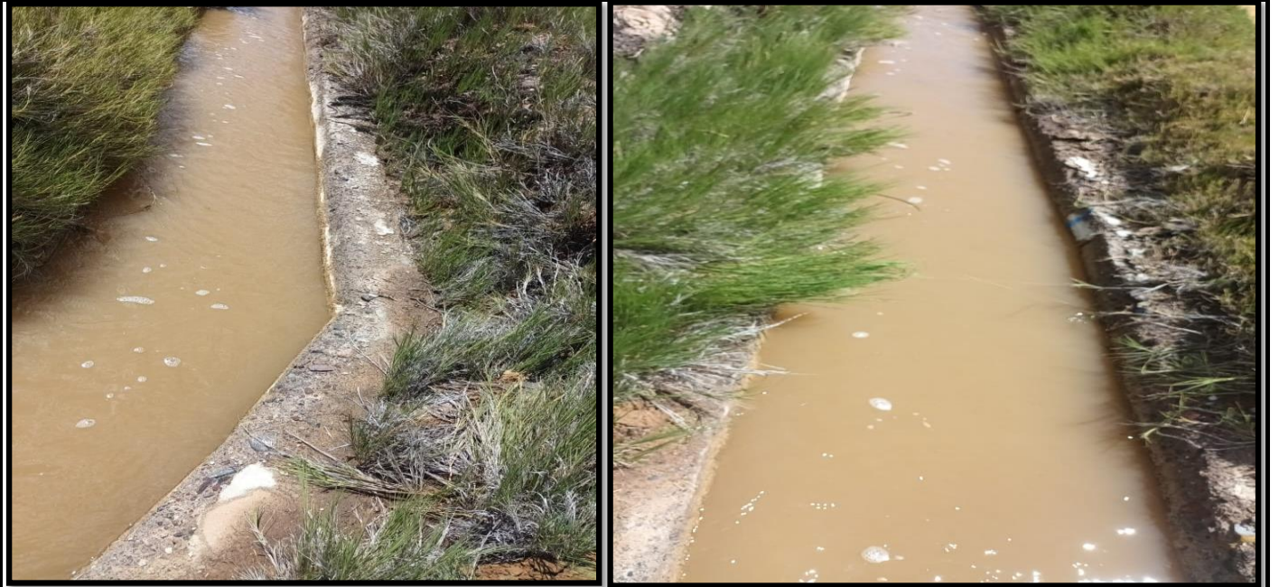
EROSION DEL MURO DE CANAL EN LAS PROGRESIVAS 04 + 460 HASTA PROGRESIVA 04 + 480
