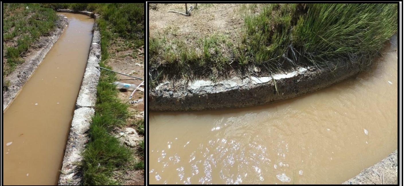
EROSION DEL MURO DE CANAL EN LAS PROGRESIVAS 04 + 620 HASTA PROGRESIVA 04 + 640
