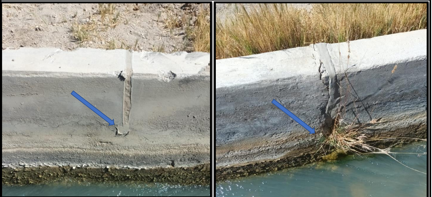
PROGRESIVA 04+260 Y PROGRESIVA 04+269 PRESENTAN DISCONINUIDAD DE JUNTAS DE DISIPACION
