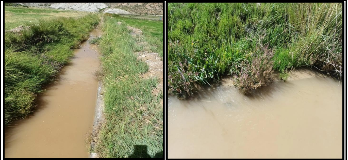
EL CANAL EXISTENTE NO CUMPLE LAS PENDIENTES MINIMAS, EL CUAL OCASIONA SEDIMENTACION Y DESBORDE DEL FLUJO DE AGUA
