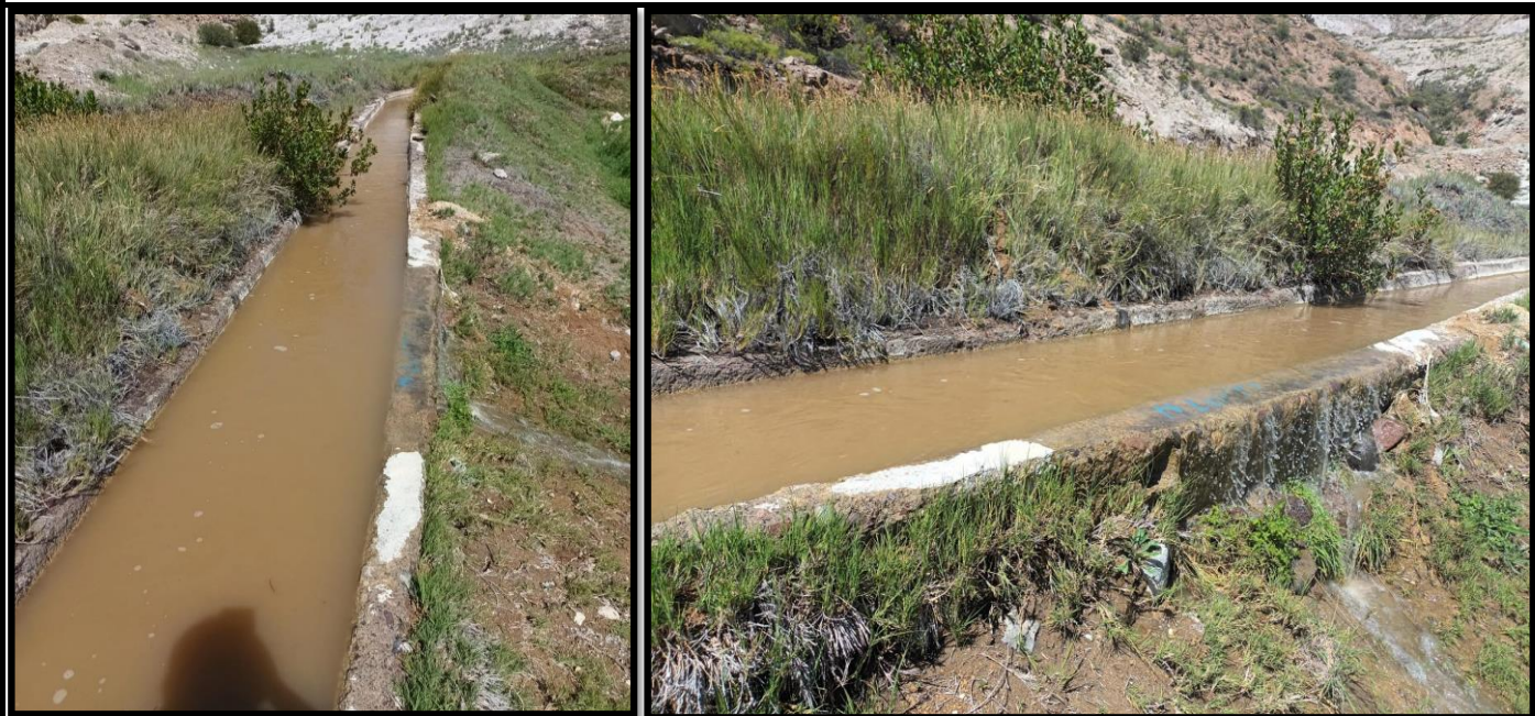
PROGRESIVA 04 + 540 DEFORMACION DE CANAL Y PERDIDA DE TALUD LATERAL / DESBORDE DE AGUA
