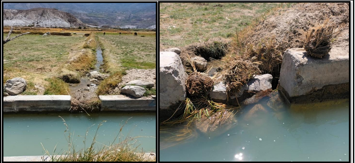
PERDIDA DE CAUDAL EN TOMAS LATERALES IMPROVISADAS EN LAS PROGRESIVAS 04 + 330 Y PROGRESIVA 04 + 410
