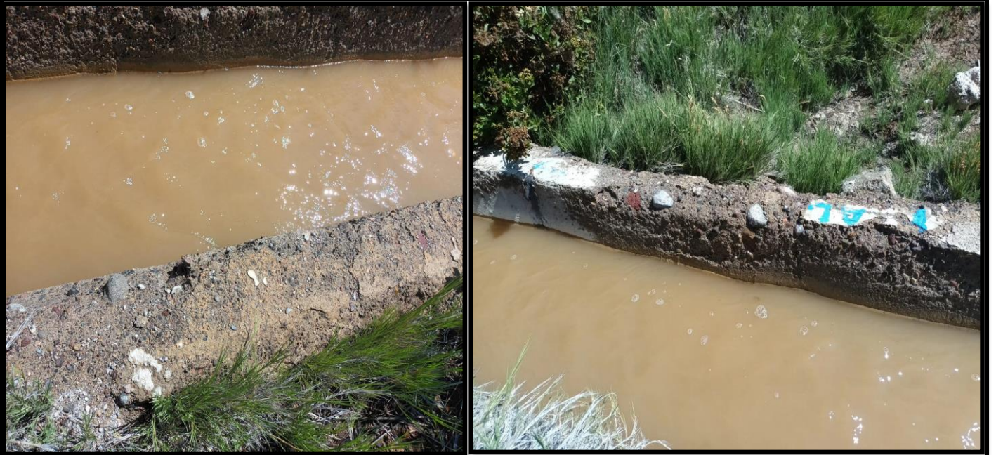
EROSION DEL MURO DE CANAL EN LAS PROGRESIVAS 04 + 570 HASTA PROGRESIVA 04 + 580
