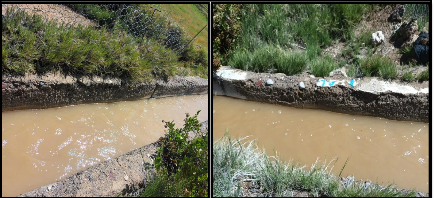
EROSION DEL MURO DE CANAL EN LAS PROGRESIVAS 04 + 660 HASTA PROGRESIVA 04 + 670
