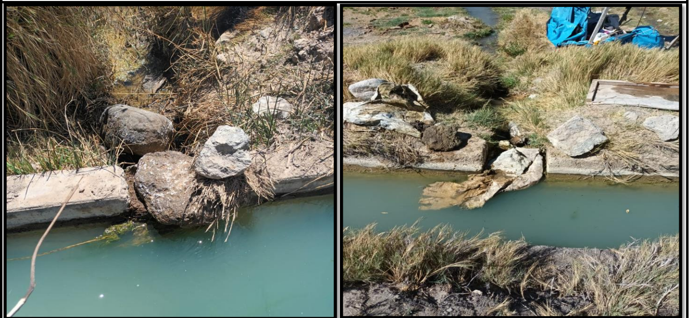
TOMAS LATERALES IMPROVISADAS EN LAS PROGRESIVAS 04 + 230 Y PROGRESIVA 04 + 250
