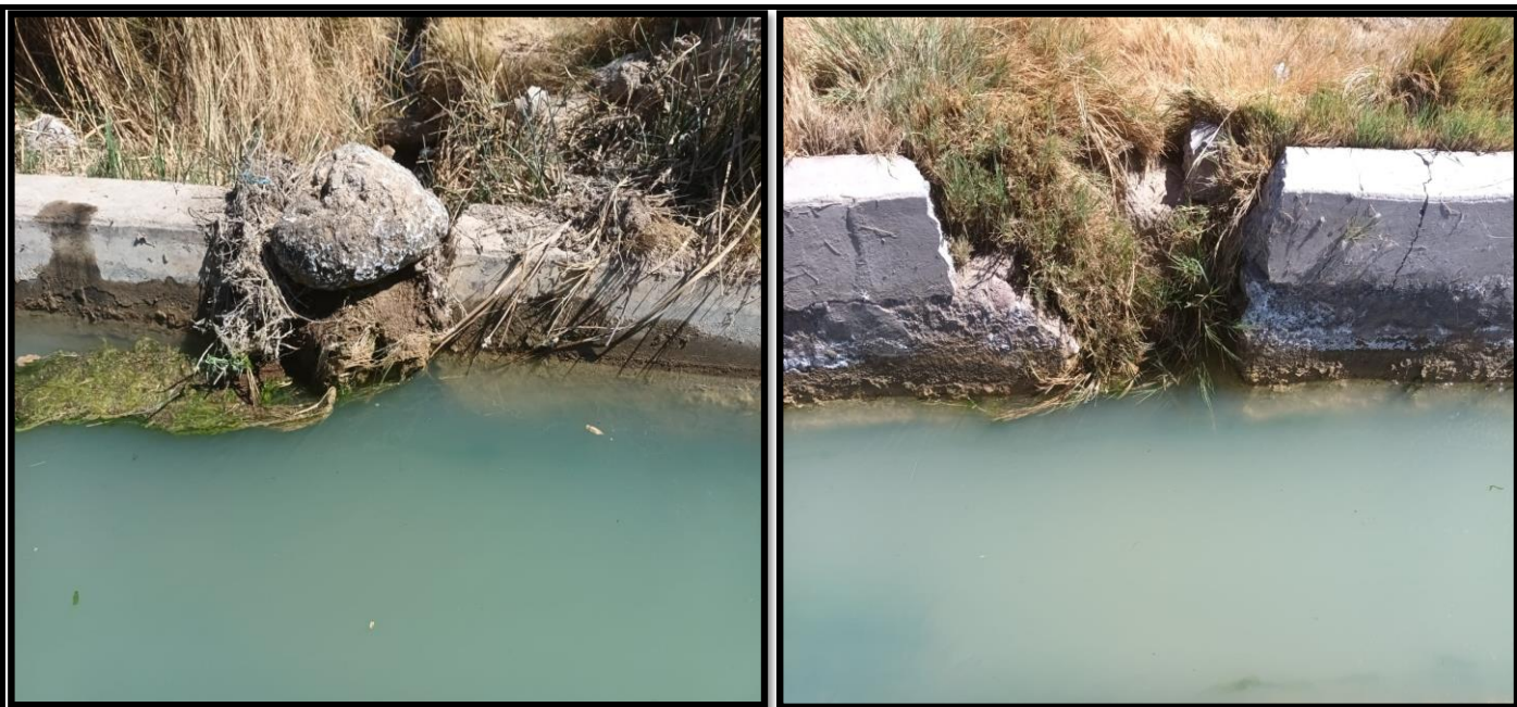
TOMAS LATERALES IMPROVISADAS EN LAS PROGRESIVAS 04 + 570 Y PROGRESIVA 04 + 675
