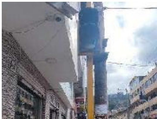
Se observa semáforo peatonal parcialmente operativo en la intersección Jr. Ramon castilla y Av. Andahuaylas
