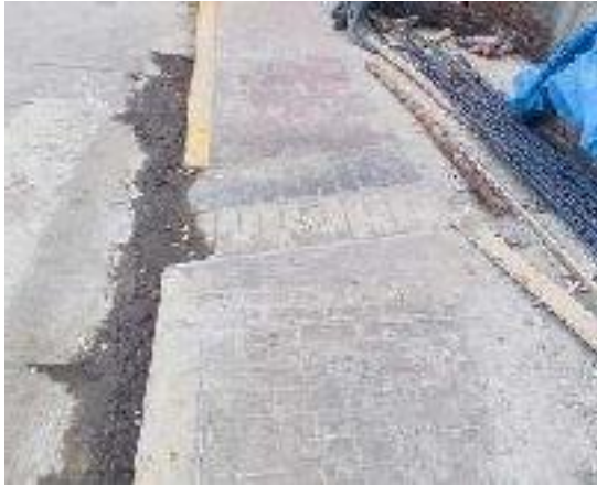
Se observa rampa de discapacitados sin pintar y totalmente obstaculizada.
