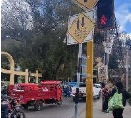
Se observa señal dos sentidos de tránsito (P-25) improvisada y con texto que no cumple con los tamaños permitidos.
