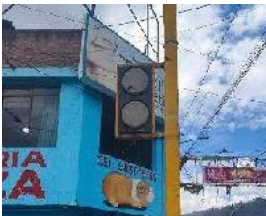
Se observa semáforo peatonal totalmente inoperativo en la intersección Av. Martinelli y Av. Ejercito.
