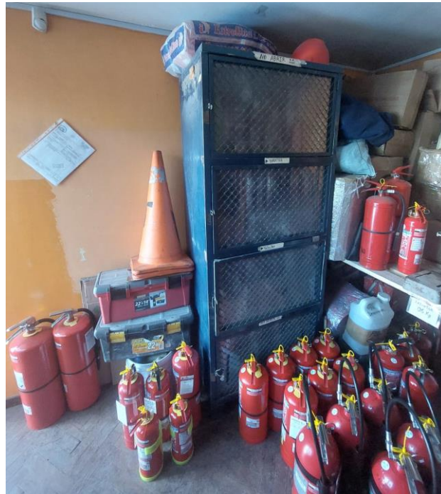
Figura 20. Evidencia de apilamiento de mercadería no identificada y extintores colocados de manera aleatoria.
