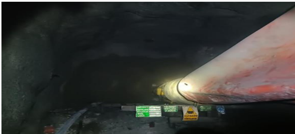
Figura 14. Ventilador auxiliar AIRTEC de 30,000 cfm del Nivel 20
