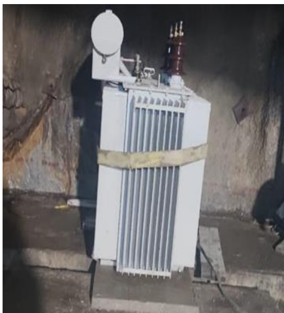
Figura 32. Transformador de 500 kVA.
