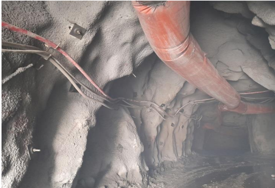
Figura 4. Cableado eléctrico en socavón.
