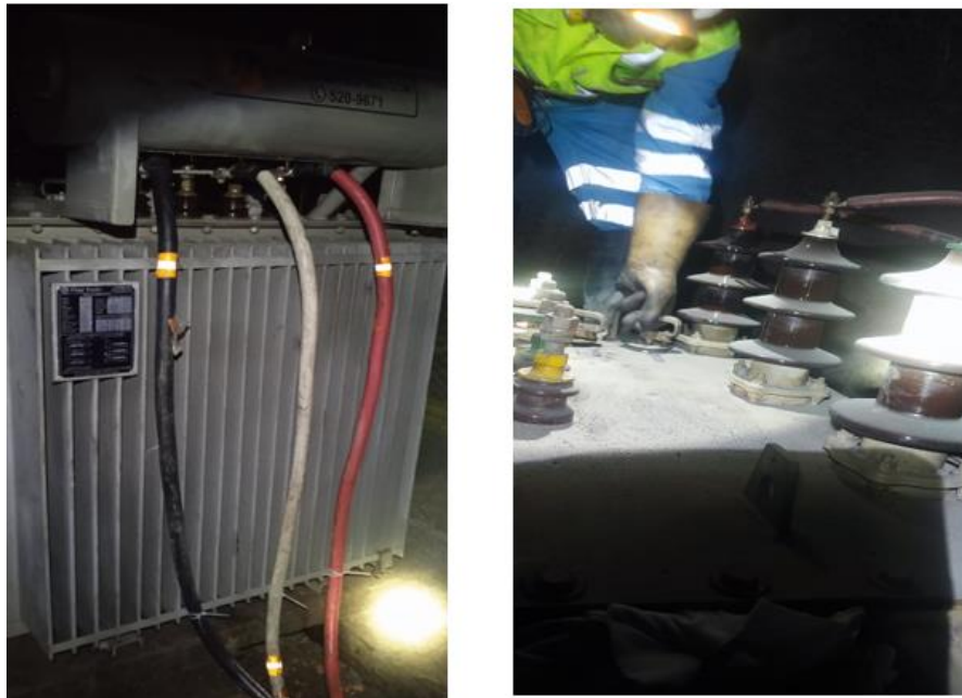
Figura 26. Conexión de los cables de media y baja tensión en la subestación.
