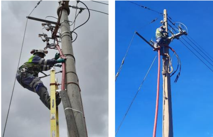
Figura 29. Bloqueo de la subestación del NV 0.
