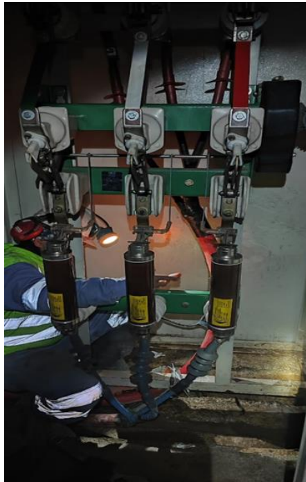
Figura 28. Conexión del cable de media tensión a las fases de la celda.
