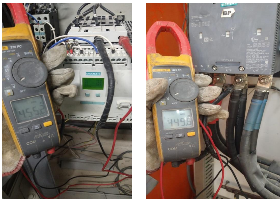
Figura 33. Medición de los tableros de control de los equipos.
