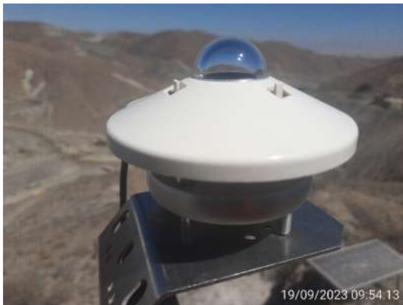
Figura 26. Instalación de sensor de Radiación Global.
