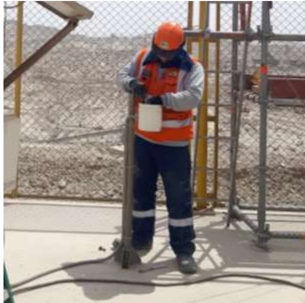
Figura 25. Instalación de sensor de Precipitación.
