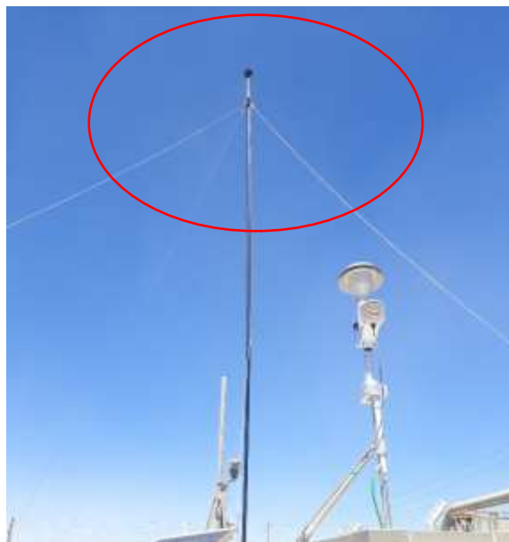
Figura 28. Instalación de sensor de Velocidad / dirección de Viento.
