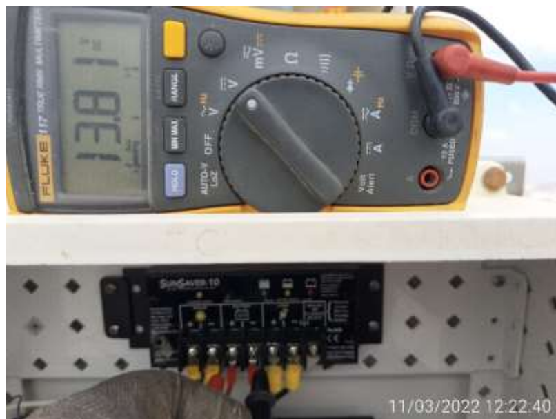
Figura 29. Instalación de sistema de energía de 12 voltios.
