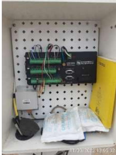
Figura 30. Instalación de equipo Datalogger.
