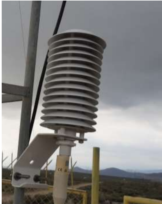
Figura 23. Instalación de sensor de Temperatura / Humedad.
