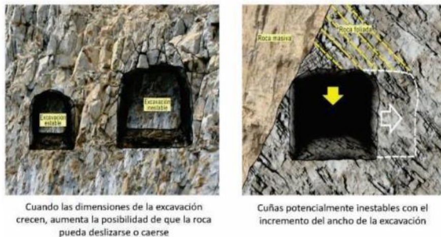
Figura 8. A mayor tamaño de la excavación se favorece la inestabilidad. (15)
