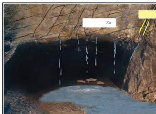
Figura 4. Presencia de agua subterránea
